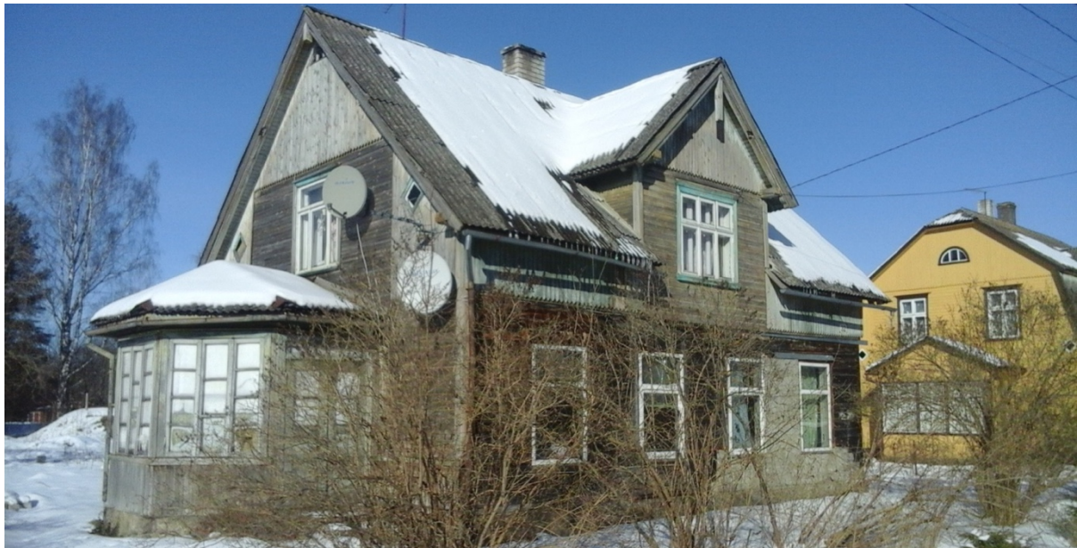
Illustratsioon 11. Lõunapoolse fassaadi uv-kahjustus
