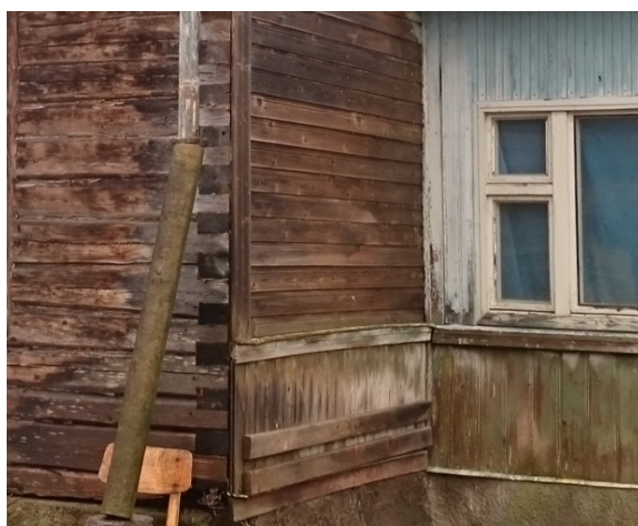
Illustratsioon 8. Palkseina veekahjustus
