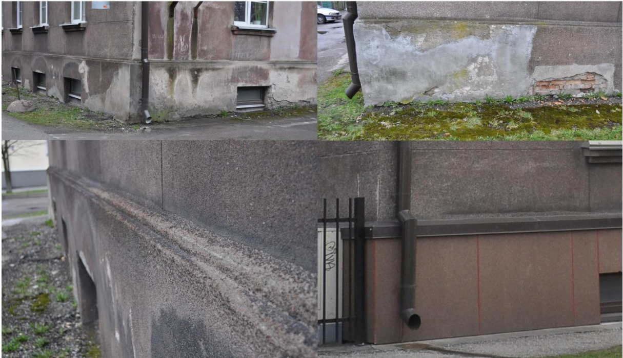
32. Sokli tsementmördiga tehtud parandused. Vihmaveetorust tulev vesi ei voola maapinna ebapiisava kalde tõttu hoonest eemale, vaid vastu seina. Seina üleminek soklile. Koidu 7 analoogne sokkel on soojustatud ja viimistletud ehitusplaadiga, serv kaetud plekiga – selline lahendus toimib küll funktsionaalselt, kuid restaureerimise seisukohast on see väär ja taolist lahendust tuleb vältida.
