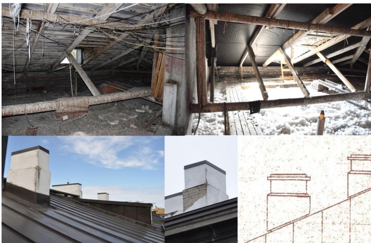
29. Katusekonstruktsioonid enne ja pärast 2010. aasta remonti. Sarikatele on lisatud diagonaaltugesid, vahelagi soojustatud puistevillaga, uue katusekatte alla on paigaldatud aluskate. Uus valtsplekk-katusekate on teostatud korrektselt. Vale korstnapitsi lahendus ja selle tulemusena lagunev korsten. Korstnapitsi kuju projektis.
