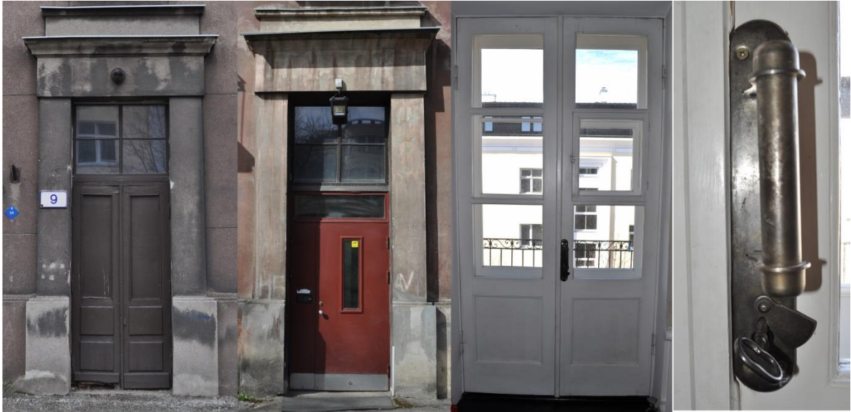
22. Välisüksed. Peaukse klaasosad on vineeriga kinni löödud. Hoovi poole on paigaldatud sobimatu metalluks. Renoveeritud rõduuks õhutusaknaga ja ukse originaalkäepide.
