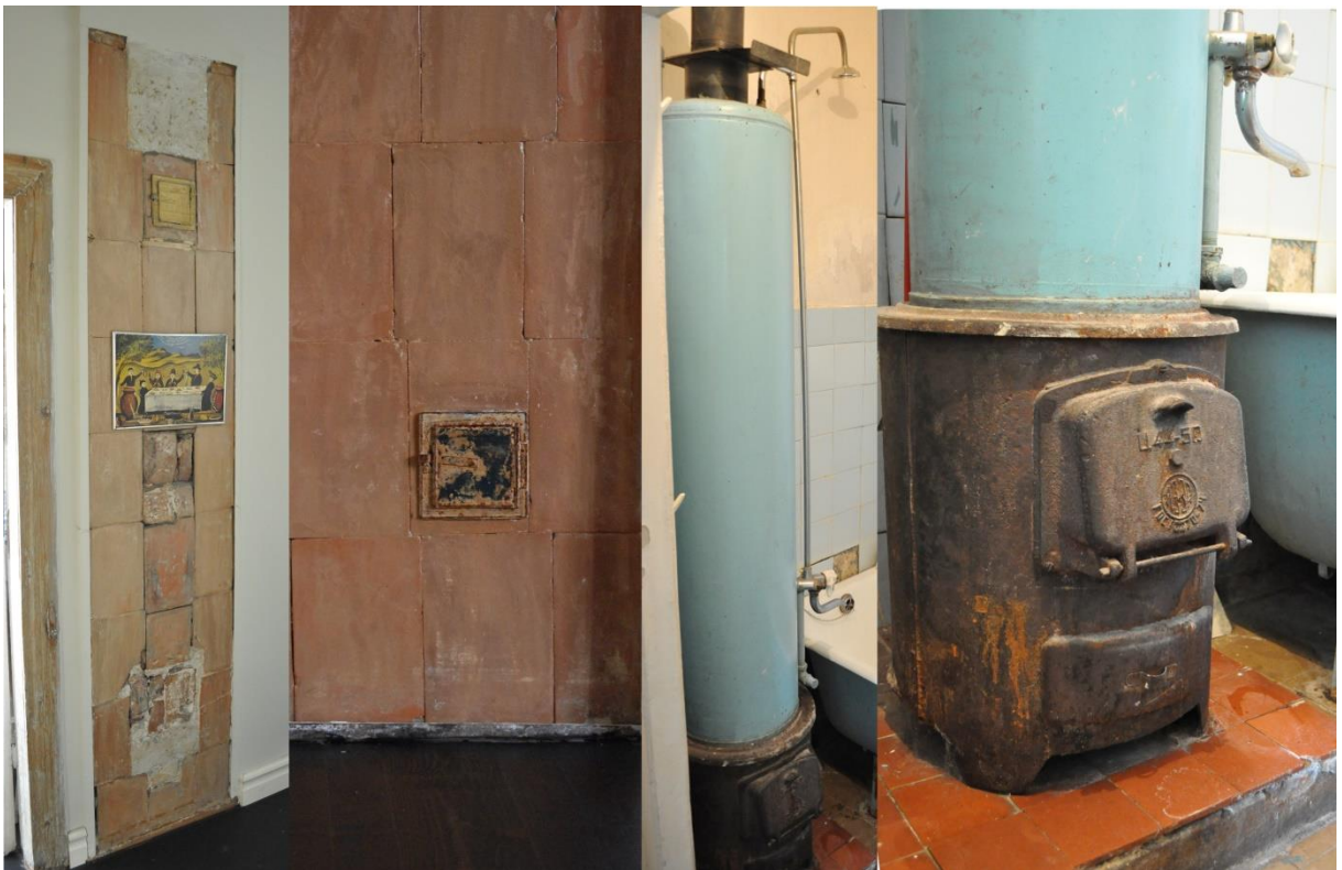
28. 1950. aastate küttekahad. „Täisbetoneeritud“ ahi– ahjusuu asus esikus, ahi paikneb kahe toa vahelises seinas. Vanniahju alumises osas on malmist küttekolle, selle peal silindriline mahuti vee soojendamiseks.
