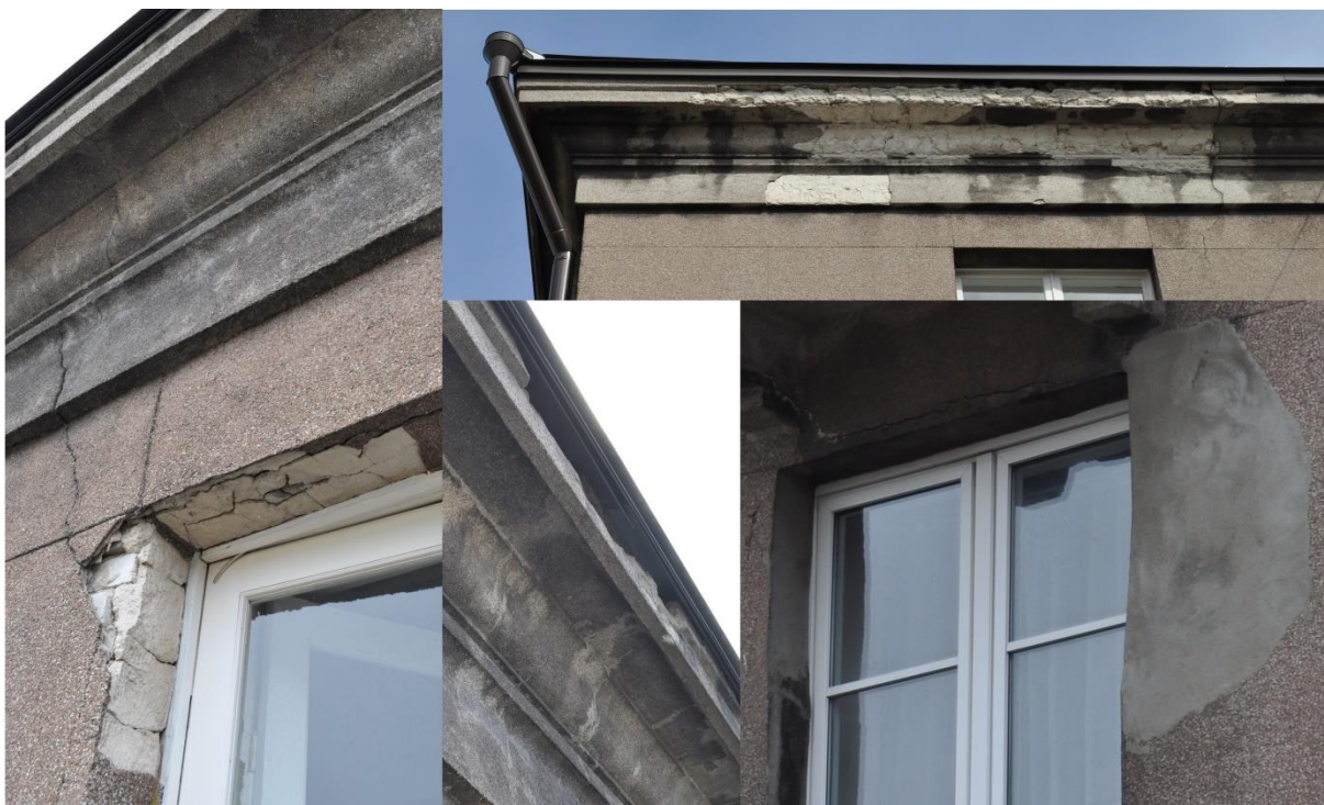
30. Varisemisohtlikud karniisiosad ja aknapõsed. Raskesti ligipääsetav karniisiosa katusepeki serva all. Tsementseguga tehtud parandused tuleb eemaldada ja uuesti krohvida terrassiitkrohviga.
