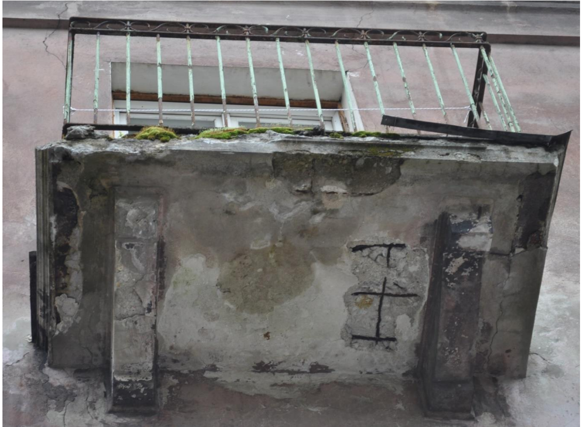
31. Amortiseerunud ja varisemisohlike osadega hoovipoolne rõdu. Terrassarrused roostetavad. Rõduplaadi servades on näha raudteerelssidest konsolidid, mille betoonpõrand toetub. Servapleki asemel kasvab sammal. Metallpiire on heas taastatavas seisukorras.
