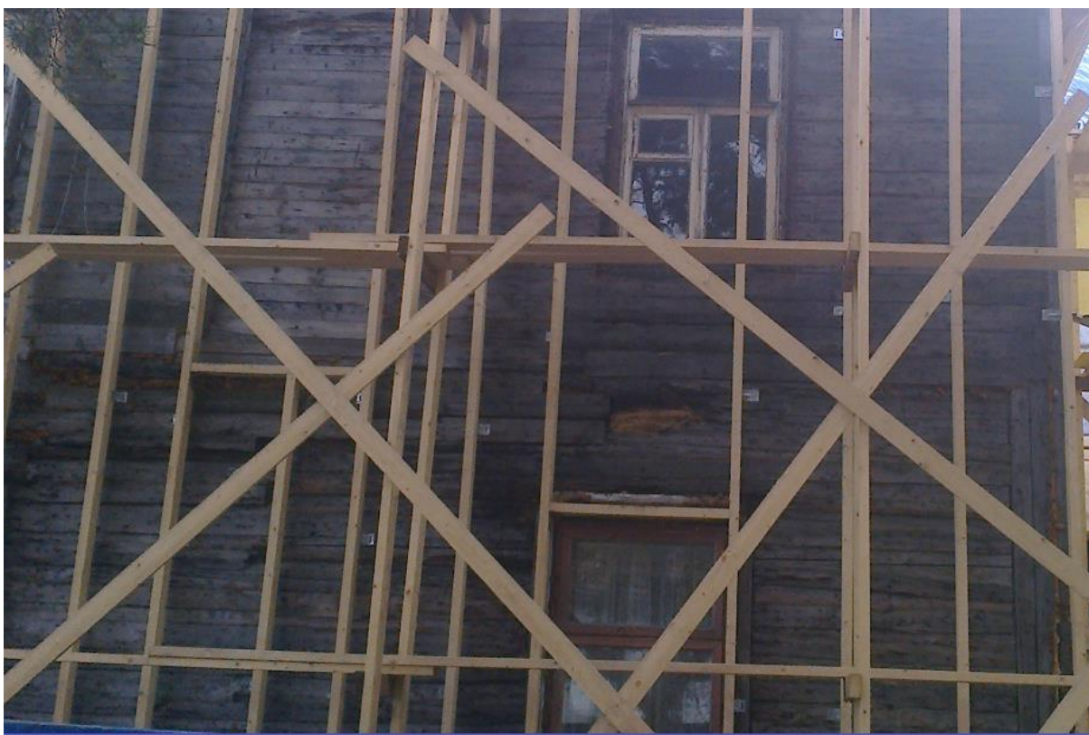
Foto 4 Vaade hoone keskosa loodepoolsele sfassaadile. Näha on puidumädaniku kahjustused
