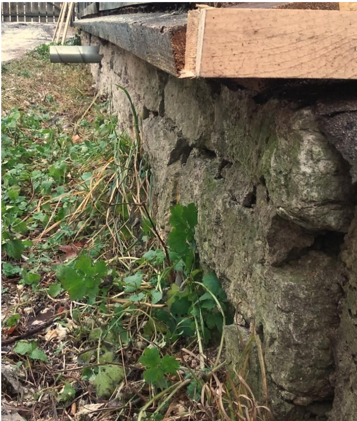
Foto 6 Fotolt pole väga aru saada, kui palju sokkel kahjustada on saanud, kuid keldrist on läbi sokli pragude ja vuukide välisvalgust näha
