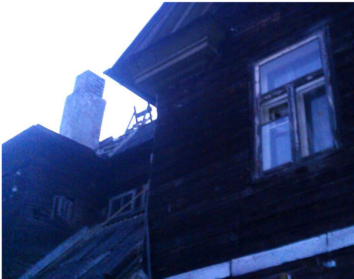
Foto 5 Vaade hoone kagu loodepoolsele sfassaadile. Näha on puidumädaniku kahjustused ärkli akende ümbruses
