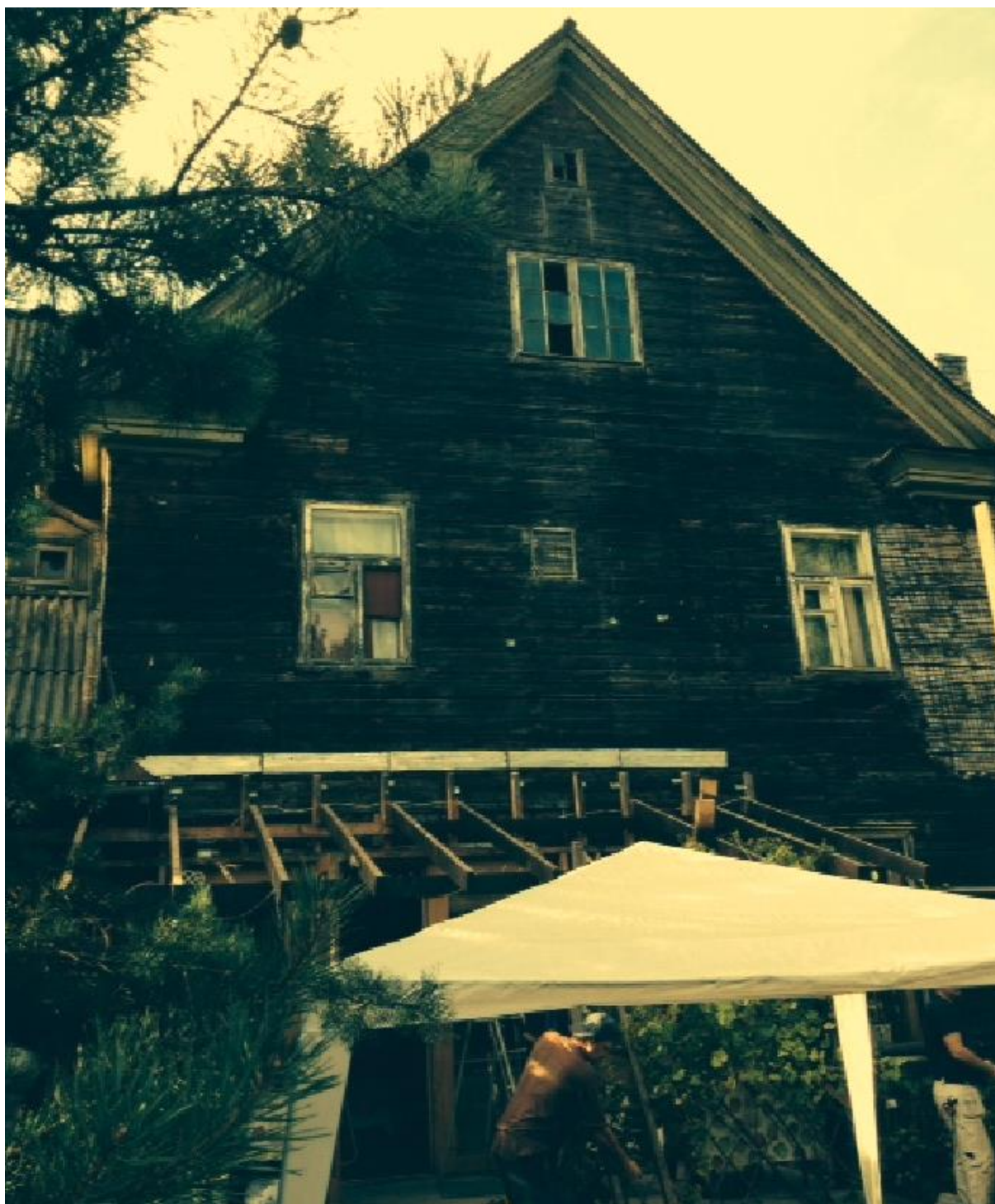
Foto 7 Vaade kagupoolsest sisehoovist fassaaditiiva ja keskosa ühendusnurgale. Fassaadile ise juurutatud varikatus lammutamise etapis
