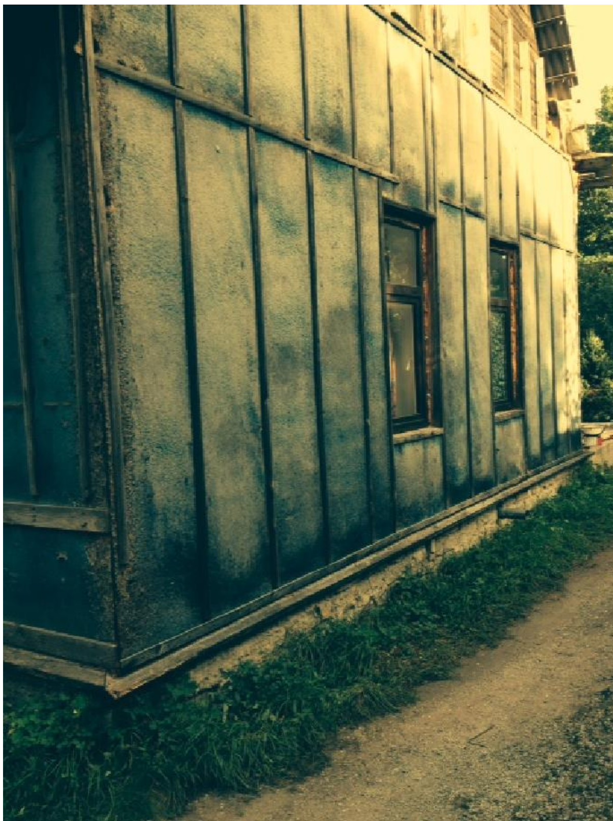
Foto 8 Fassaadi soojustamine on lõpetatud Iikorruse akna all ja vihmavesi jookseb mööda fassaadi soojustuse vahele.
