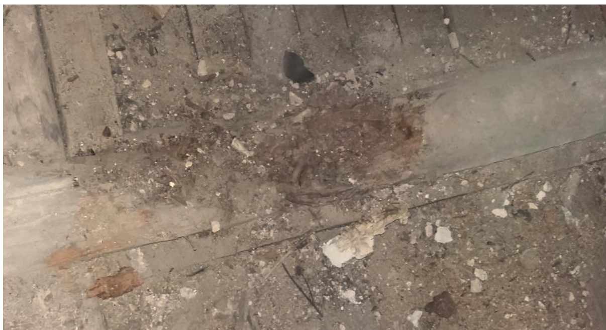
Foto 9 Pööningukorruse tala millele on vihmavesi otse peale tilkunud, üle poole palgist täiesti pudi.
