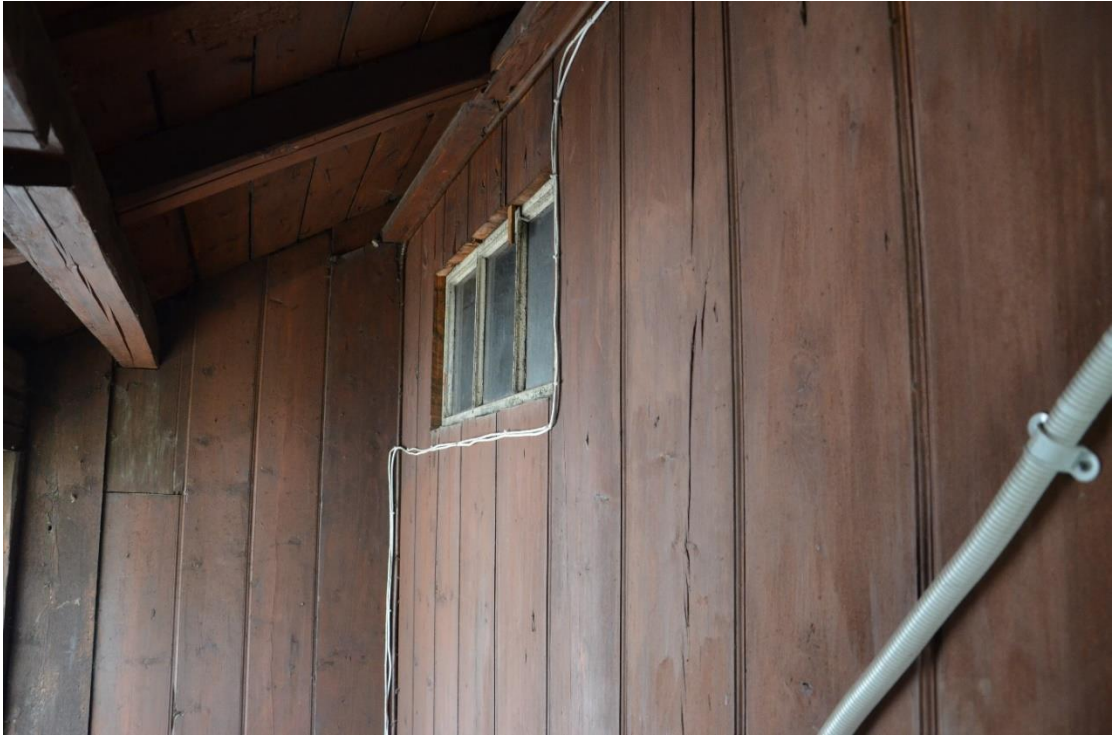
35 Kolme ruuduga aken trepikojas koridori ja korter 4 panipaia vahel. Näha ka trepikoja laia püstlaudist ja katusekonstruktsiooni.
