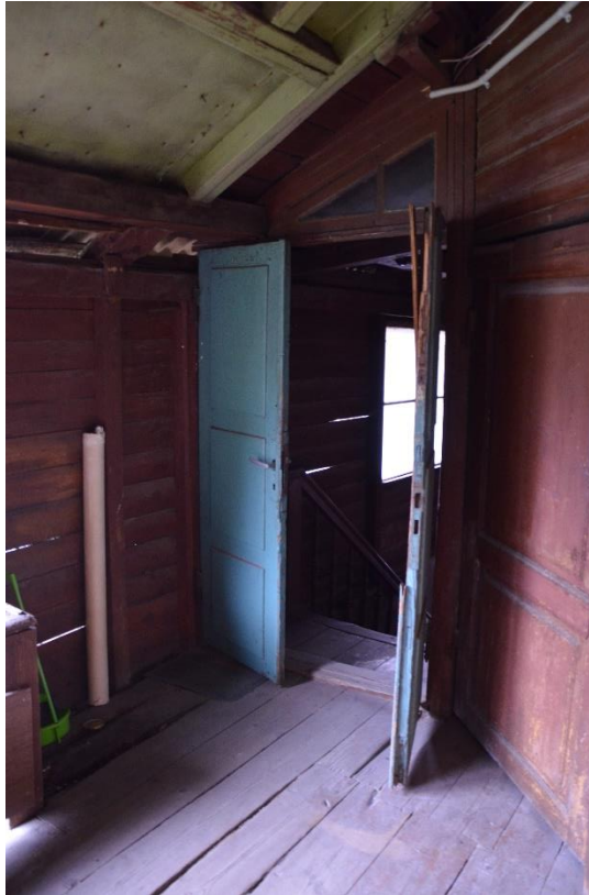
37 Aken trepikoja ja koridor-rõdu vahel. Hästi näha ka parempoolse ukse niiskuskahjustust ülaseras.
