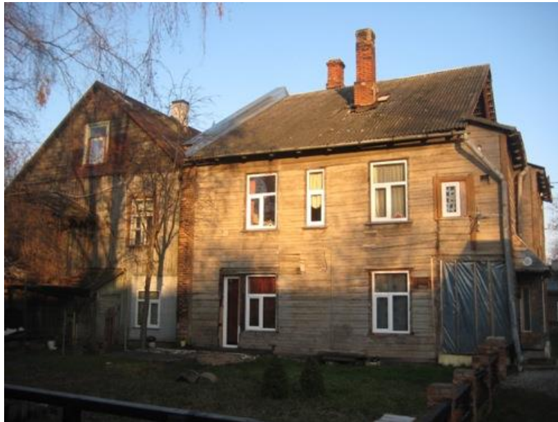
16 Vaade Filosoofi 5 ja 7 majadele novembris 2011. Näha endist laudist, teise ja katusealuse korruse vanemaid aknaid, plekk-katust ning silikaattelistest korstnapitsi. Esimesel korrusel on sobimatu plastikaken juba ees. Foto Mari Nõmmemaa 15 .
