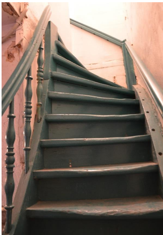
44. Kolmandale korrusele viiv trepp. Enamik pulkadest on kadunud. Näha ka koridori krohvitud ja valgeks värvitud seinu.
