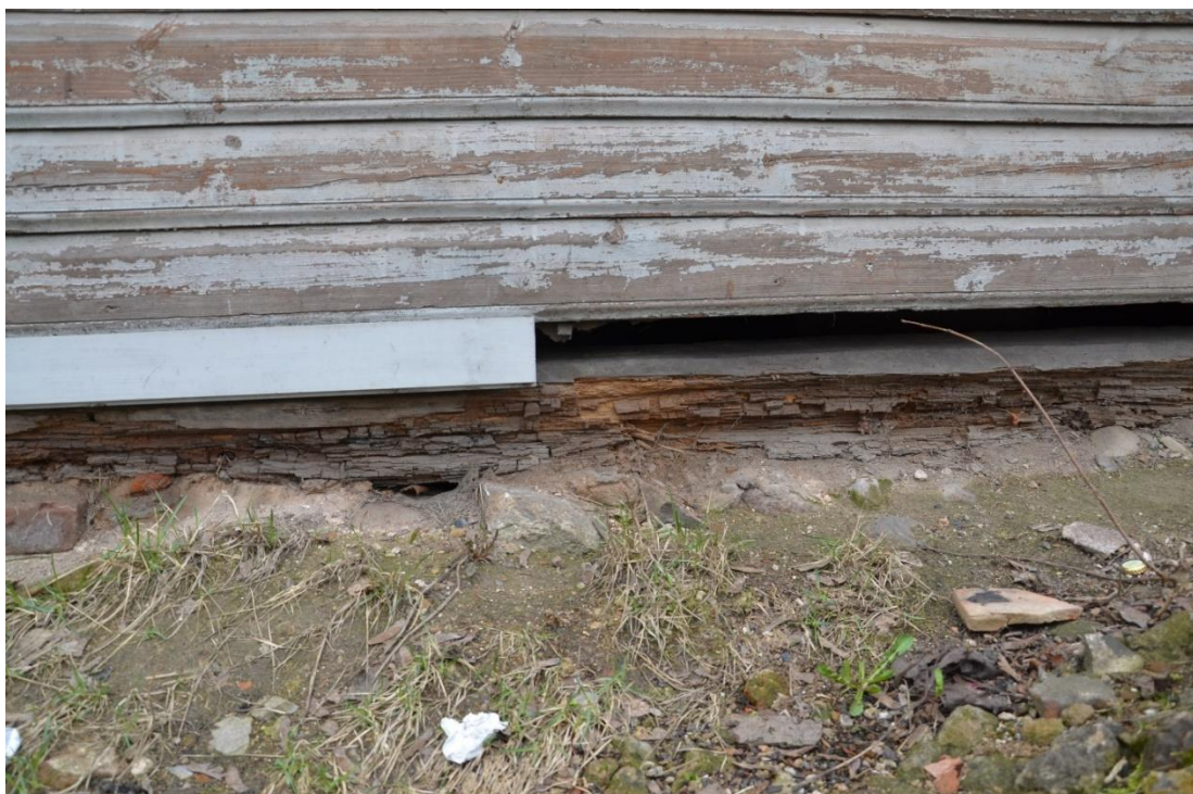
22 Maja põhjakülje sõrestikkonstruktsiooni alumine palk, üsna pehkinud.
