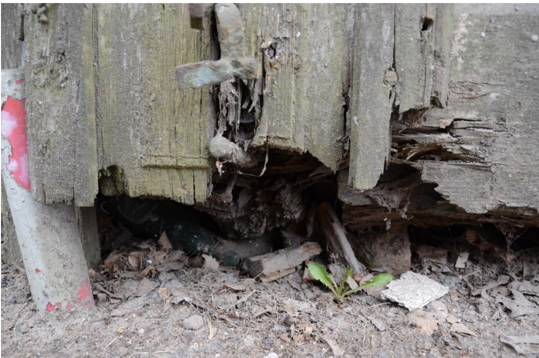
20 Vaade maja lõunanurgale. Näha liseeni pehkinud alumist otsa millegi, tõenäoliselt vihmaveetoru, kinnitusklambri, sügavamal voodrilaua pehkinud alumised palgid. Vundamenti näha ei ole.
