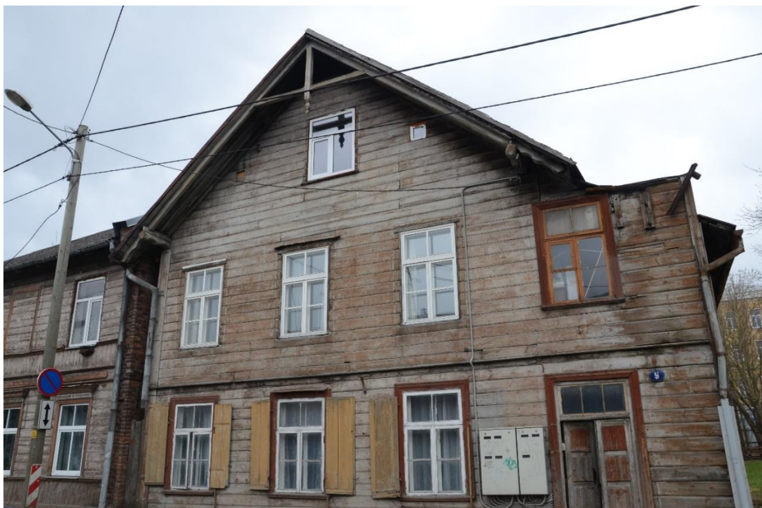
33 Tänavapoolne fassaad, aknad. Osaliselt näha ka vana uks ning profileeritud sarikaotsad ja esimese korruse aknaluugid. Silma riivab elektrikilp uksest vasakul.
