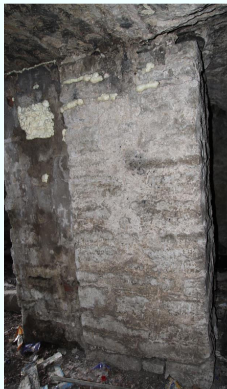
Foto 22. Suletud ventilatsiooniavad lõunapoolses keldriruumis.
