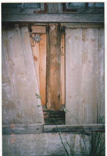
Ill 4. Suur-Sadama 23 konstruktsioon (hoone hävinud).
