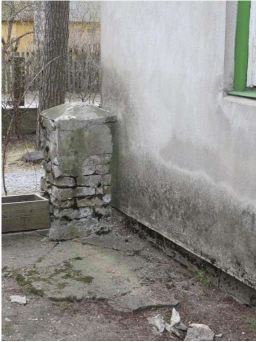
Foto 40. Niiskuskahjustused hoone fassaadil. Pildi näha ka paekivist terrassipost.
