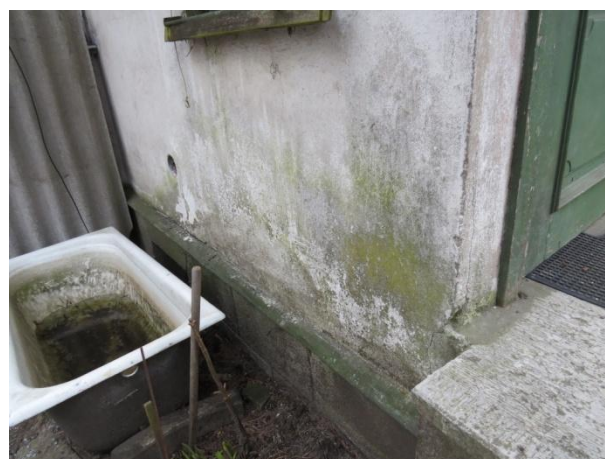
Foto 39. Niiskuskahjustus hoone idanurgas.
