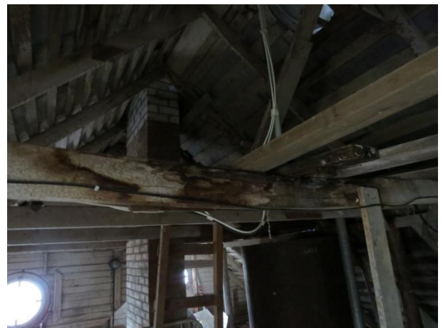
Foto 31. Niiskuskahjustus neljandal pennil.
