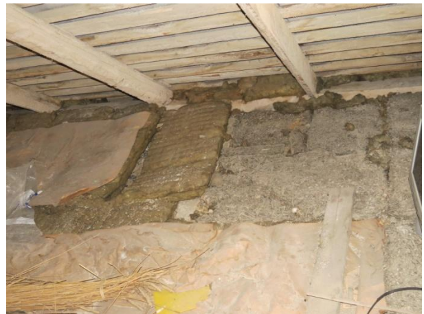
Foto 25. Pööningu osline ebakorrapärane soojustus.
