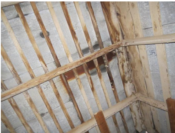
Foto 20 Katuse läbijooksust tekkinud korrosioon.
