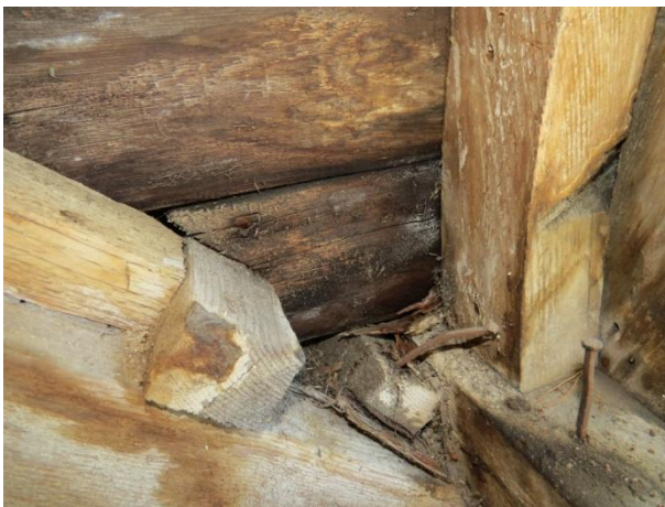
Foto 30. Valtsi läbijooksul tekkinud puidukahjustus.
