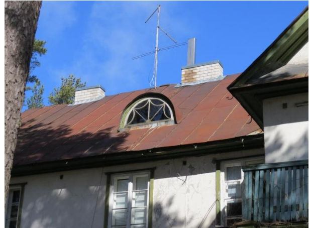
Foto 19. Poolkuu kujuline katuseaken ja korrodeerunud katusekate.
