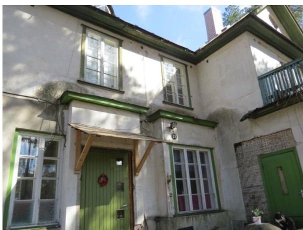
Foto 38. Niiskuskahjustused hoone peafassaadil.
