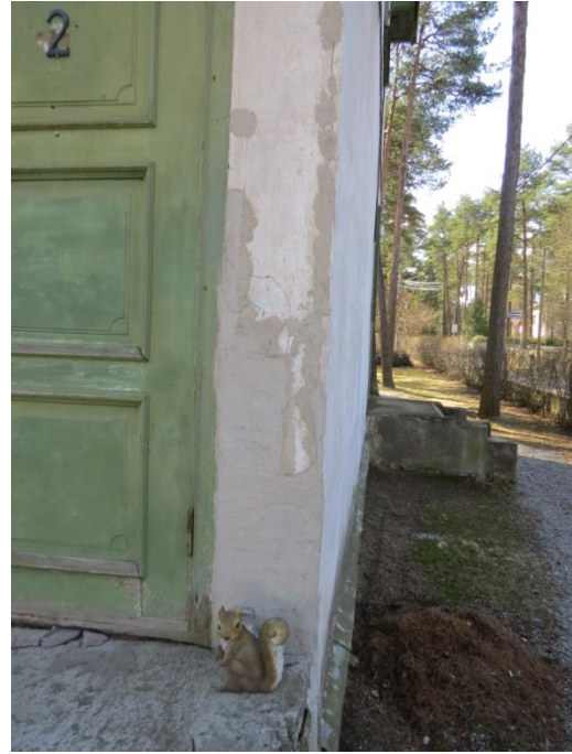
Foto 41. Tsementkrohviga tehtud parandused hoone põhjanurgas.
