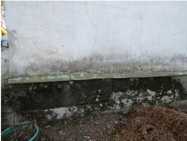
Foto 62. Niiskuskahjustus hoone loodekülje soklil.
