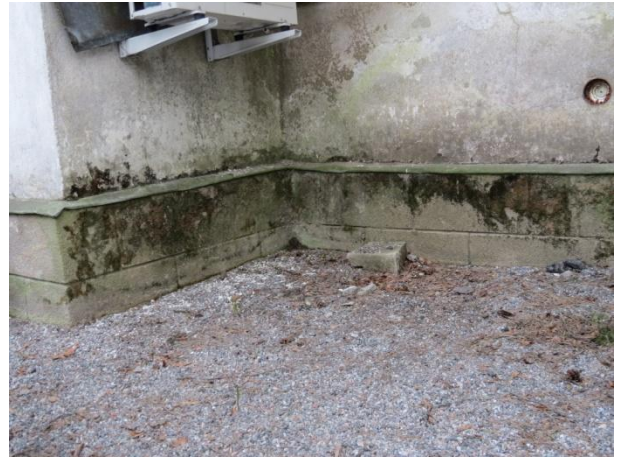
Foto 63. Niiskuskahjustus hoone kirdeseinal.
