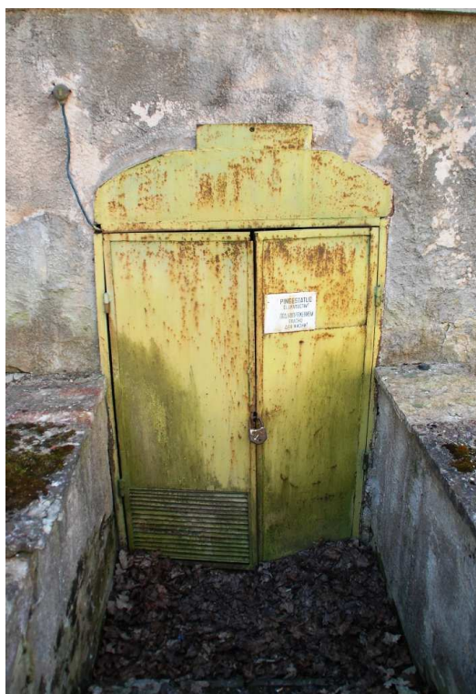
20. Hoovipoolse veranda all olevasse keldrikorruse ruumi viiv metalluks. Epp Vahtramäe, 12.04.2016
