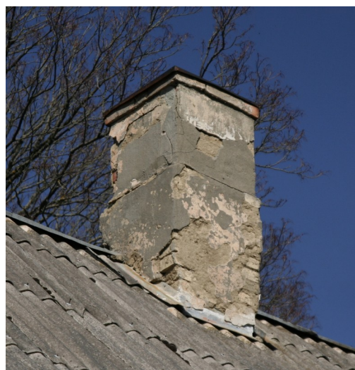
Foto 16: Elamu korstna seisukord
