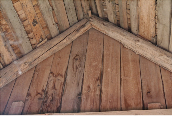
Foto 14: Niiskuskahjustused pööningu lääneseinas
