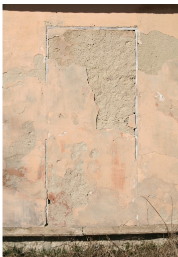
Foto 5: Ukseava raam elamu lõunafassaadis
