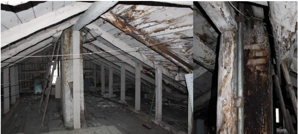
Illustratsioon 19. Vasakul – Niiskuskahjustustega katusekonstruktsioonid; Paremal – Avariilises seisukorras korstnajaalg. 20.04.2016
