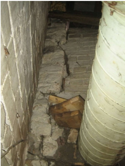
Foto 23. Pragu tulemüüri ristseinas
