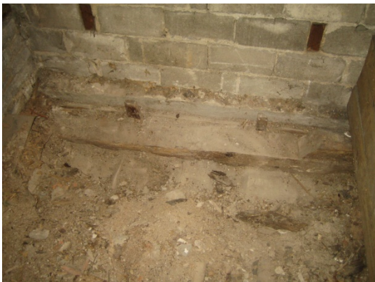
Foto 33. Uugi seinu kandev betoontala
