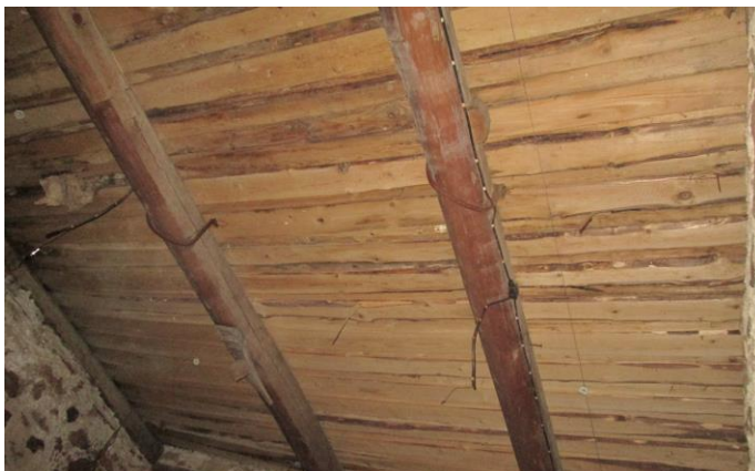
11. Lõunapoolse ruumi vahelagi. Foto: Kalle Merilai 27.04.2016.a.
