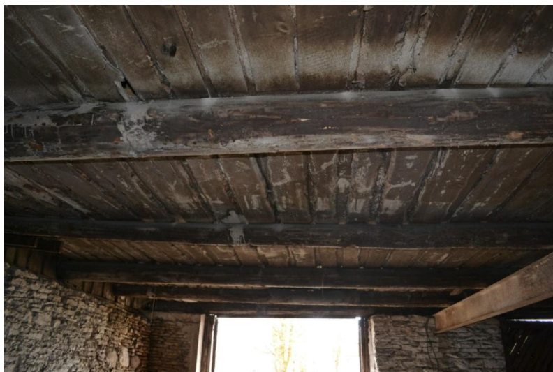
Foto 14. Mittepõlenud osa 1. korruse vahelagi
