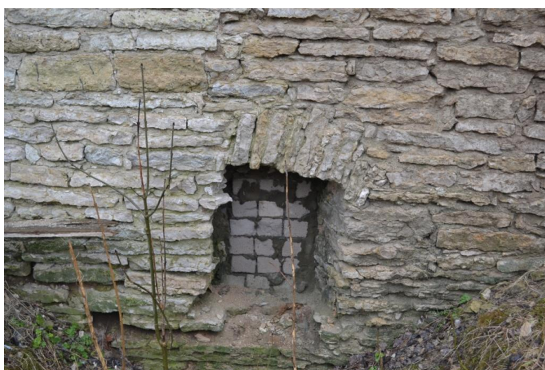
Foto 25. Kinnimüüritud keldriaken põhjaküljel
