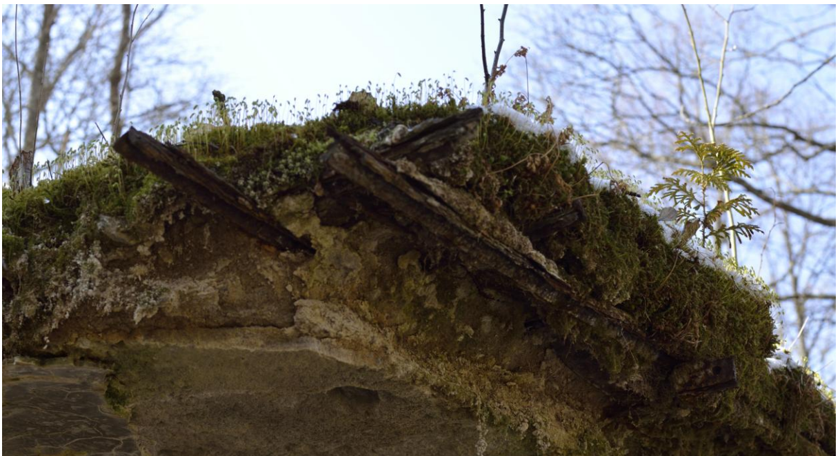
Foto 5. Raudbetooni seest kahjustuste tõttu nähtavale tulnud vinkelrauast sarrused.
