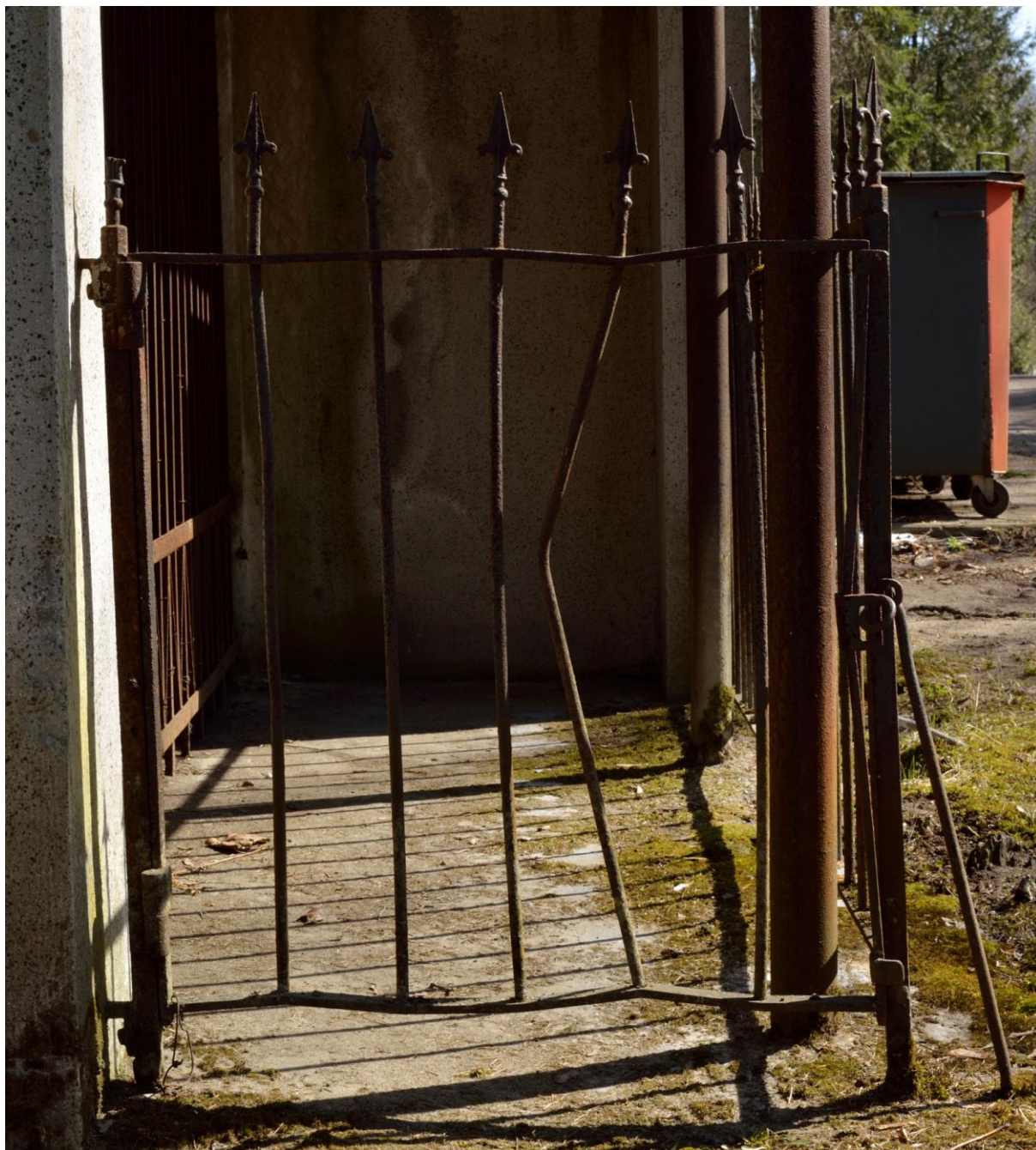
Foto 9. Deformeerunud piirdeaia raudvardad. Paremalt servas on näha kabeli katuse serva toestav ja roostetav toru.
