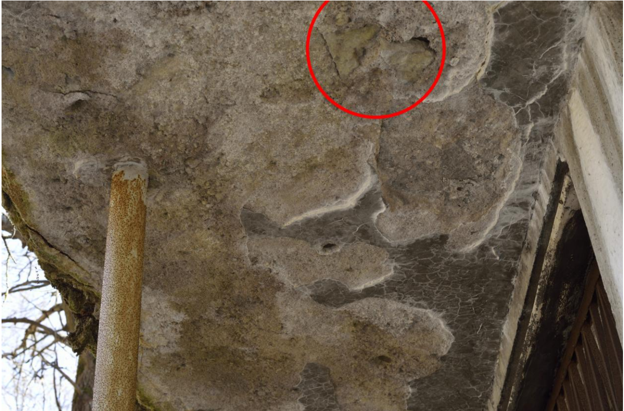
Foto 7. Punase ringiga on märgitud koht kus võib näha kabeli katuse betoonivalu sisse pandud paekivi. Ühtlasi on ka näha kui halvas seisukorras on kabeli katus altpoolt vaadates.
