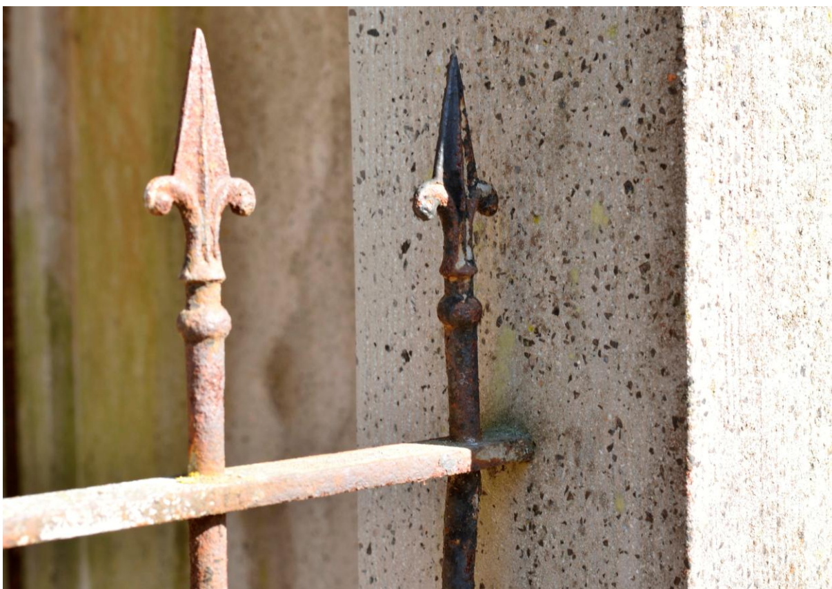
Foto 2. Sellest kuidas sepihvõred on kinnitatud raidkrohviga kaetud betoonseina külge võib järeldada, et betoonsein kaeti raidkrohviga peale sepihvõrde paigaldamist.
