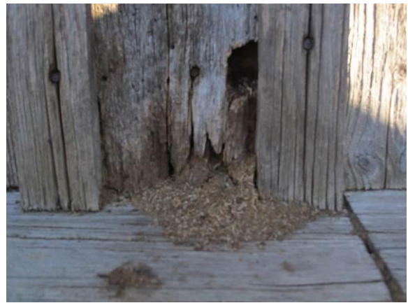
74. Laudise kahjustus, lõunafassaad
