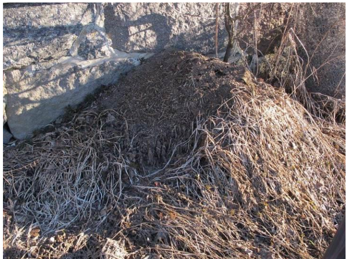
56. Sipelgapesa lõunafassaadil vundamendi ääres
