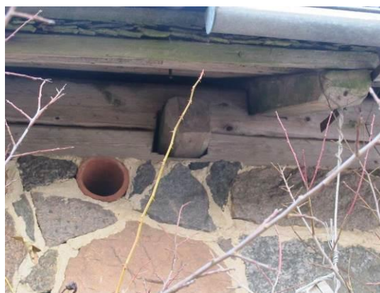
61. Aida lõunafassaad – tuulutus seina ülaosas
