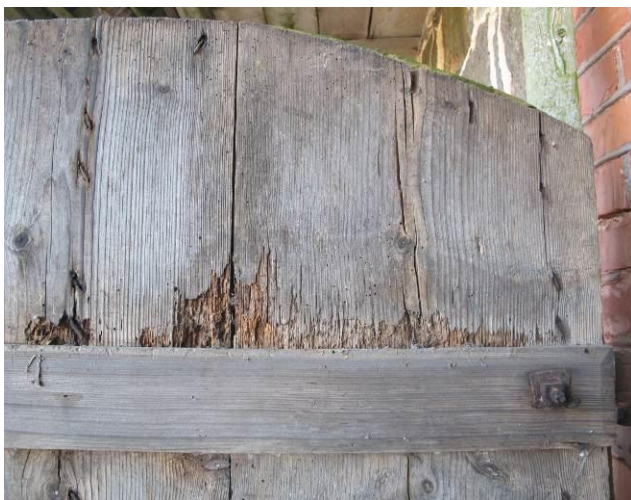
99. Kahjustatud keldriuks VU-4
