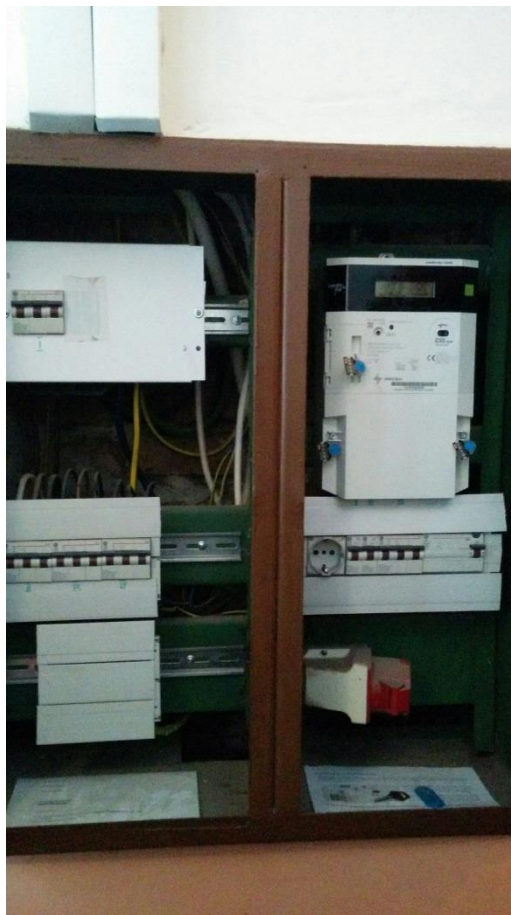
Foto 6. Kaasajastatud elektirikilp, autori foto.
