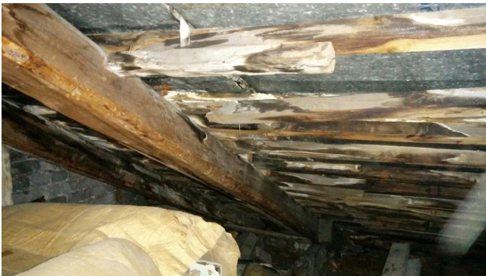
Foto 5. Katusesakrikate ja roovituse kahjustused, autori foto.
