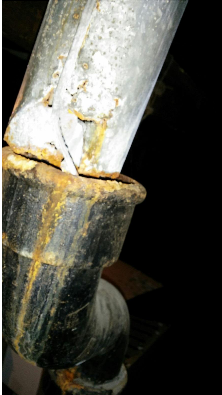
Foto 16. Kanali toru õhutus on toodud põõningule, läbiviiku katusest ei ole teostatud. Kogu niiskus koguneb katuse alla, autori foto.
