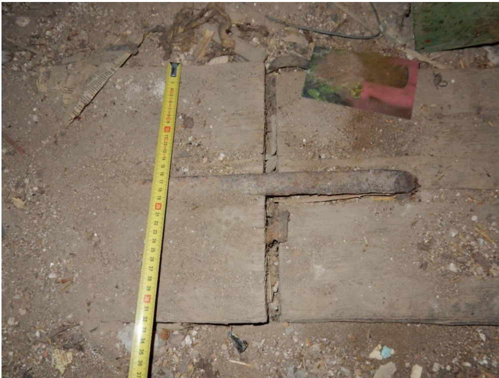
16. Vaade laetalade ühendusriisale peahoone keskel pööningutrepi juures, parempoolne laetala on vaheseina puudumise ja niiskuskahjustuste tõttu läbi vajunud, talade laius 32 cm, 25.03.2017
