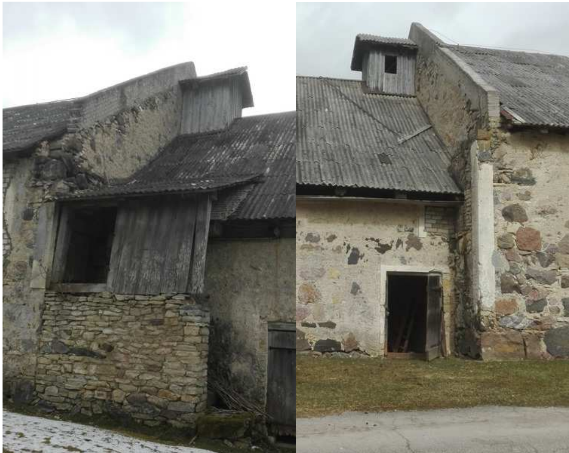
Foto 15 ja 16: Kahe hooneosa ühenduskoha vaade taga- ning esiküljelt. Kahjustusi põhjustab räästapiirkonnas olev müüri laiend, mis pole kaetud, ebatihed katusekatte ja müüri sõlm ning silikaatkivist tulemüür, mille tõttu pole võimalik katust üle müüri pikendada.
