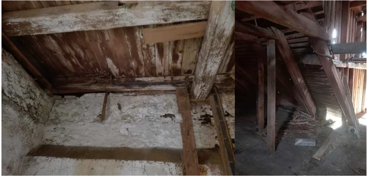
Foto 13 ja 14: Kahjustunud piirkond A1 ja A2 vaheseina kohal S-küljel – vaade I korrusel ja põõningul; murdunud 6. tala, poolsarika puuduv alumine ots ning kahjustunud põrandalaudis.
