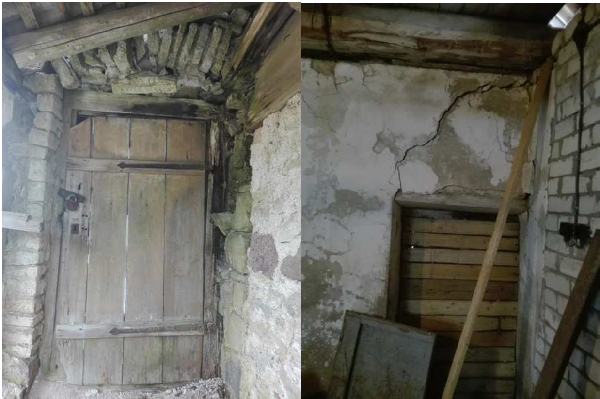
Foto 18 ja 19: Kunagiste eluruumide sissepääsu vaade välisküljelt ja seest ning müürikahjustus.
