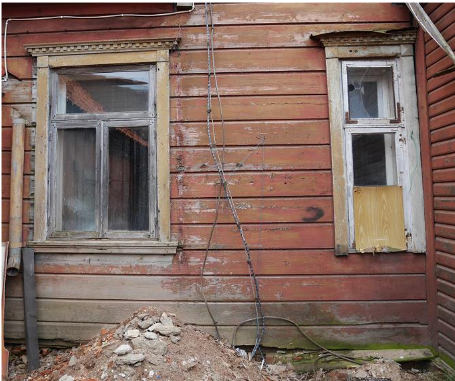
Foto 24. Ehitusprahi kuhi ja fassaadi niiskuskahjustused. Aprill 2017.
