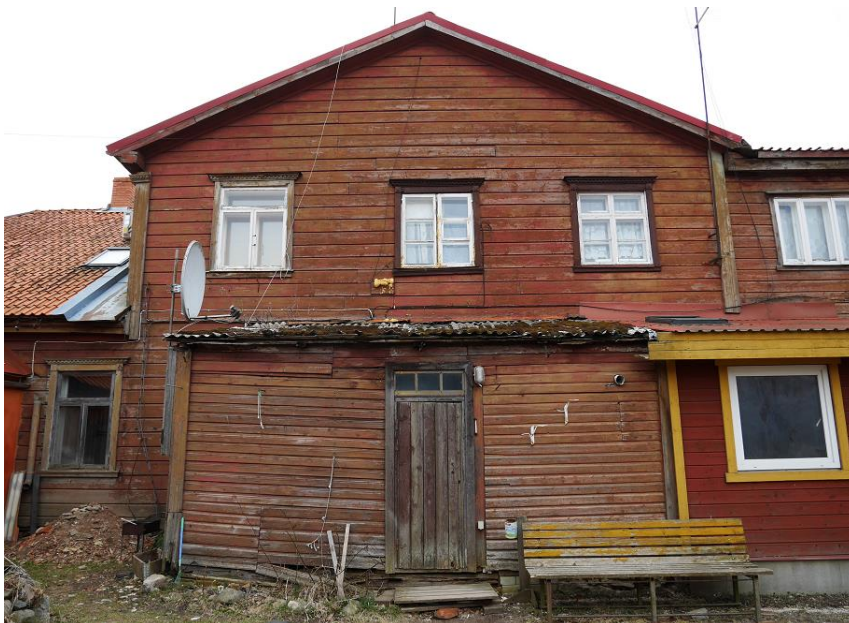
Lossi 13 hoovipoolsel küljel on katusekattena esindatud savikivi, eterniit, plekk ja tõrvapapp. Aprill 2017.
