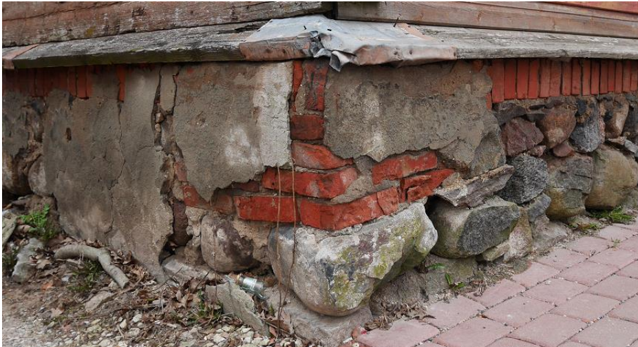
Niiskuskahjustustega sokkel ja plekiga lapitud veelaud. Aprill 2017.
