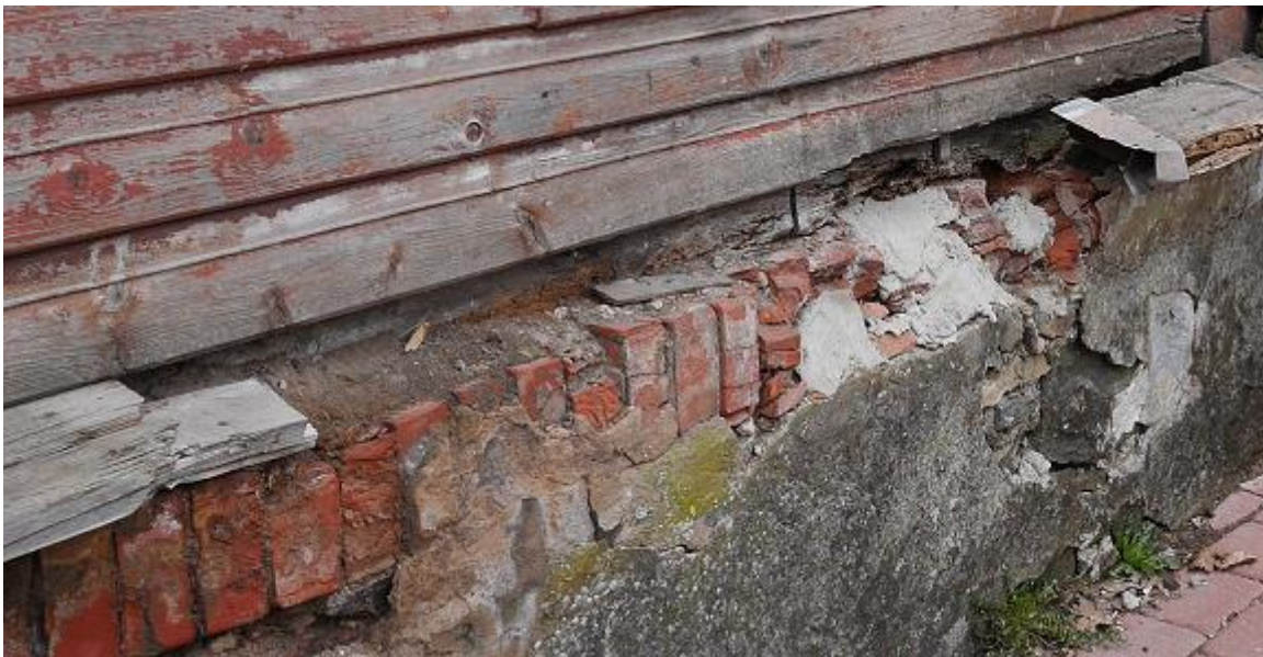
Soklipealse veelaua kohatine puudumine põhjustab niiskuskahjustuste teket seinapalkidele. Aprill 2017.
