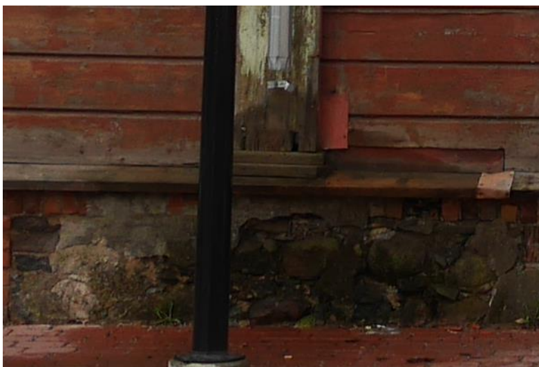
Katkine vihmaveetoru põhjustab fassaadi märgumist. Aprill 2017.
