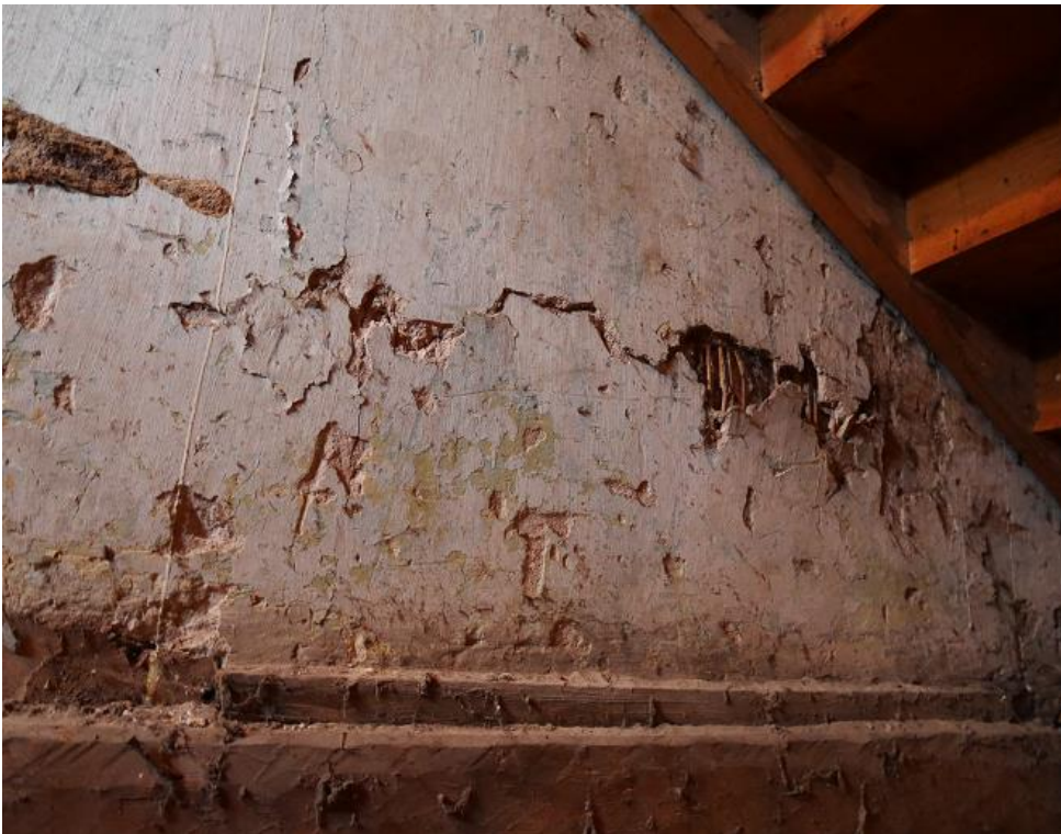
Foto 93. Keldrisein ja teisele korrusele viiva trepi alune. Aprill 2017.
