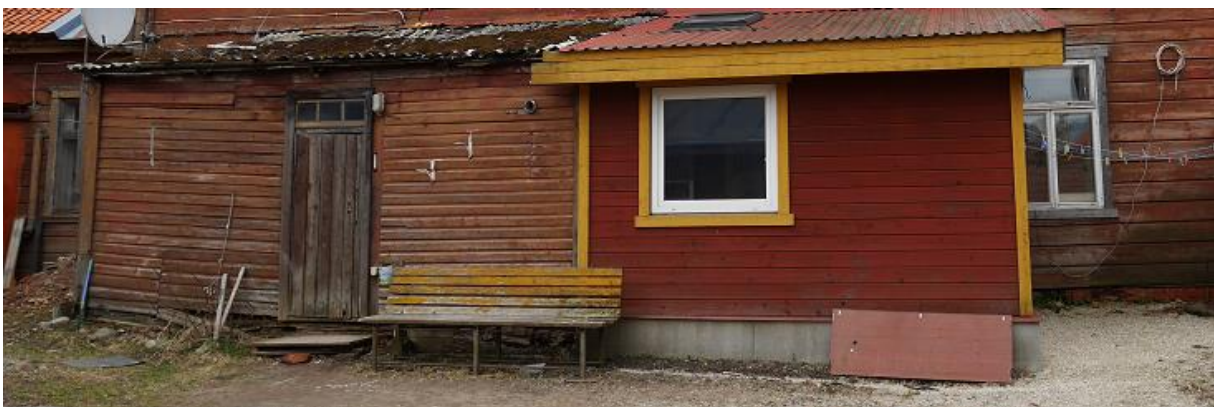
Sokli olukord hoovipoolsel küljel: pinnasesse ja ehitusprahiti mattunud sokkel Kauba tn poolses osas; kahjustused tuulekoja osas; sokliplaat krt 4 magamistoa osas; pinnasesse mattunud sokkel Kauba tn poolses osas. Aprill 2017.
