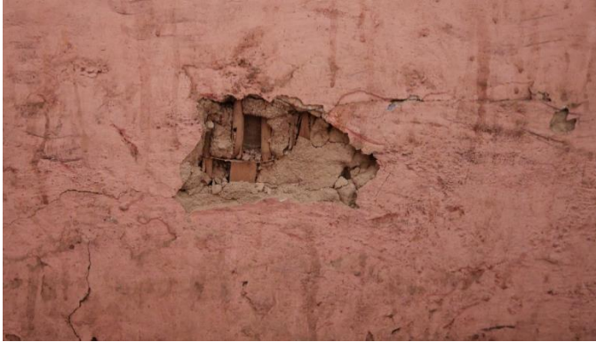
Kahjustused trepikoja seinas. Aprill 2017.
