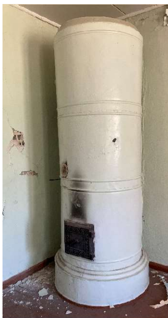
Foto 43 Värvitud ja plekk-kattega ümar ahi
