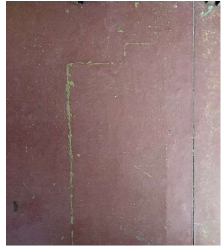
Foto 36 lammutatud seinä jälb I-korrušel ootesaali ja postiruumivahel
