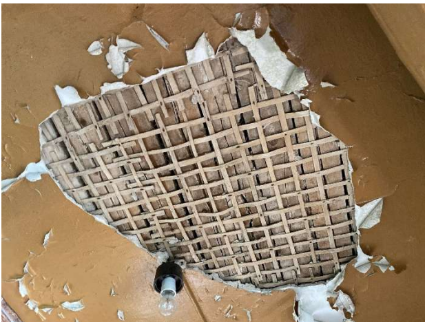
Foto 37 Katuse läbijooksust tekkinud krohvikahjustus
