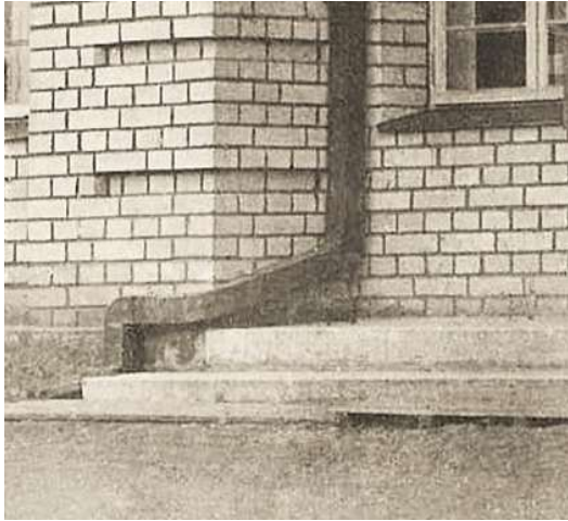
Foto 13 Vihmaveetoru kulgemine liigendatud seinal raudteepoolsel hoone küljel ootesaaliväljapääsu juures. Detail fotost Rauno Silm erakogust
