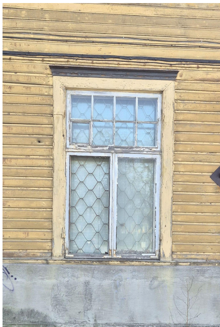
ill 74: Põhjaküljel asuva akna üks klaas on puudu.
