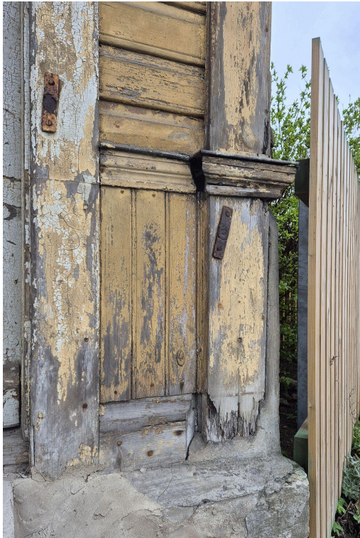
ill 50: Puuduliku vihmaveesüsteemi tõttu on ka hoone nurgk niiskuskooormuse tõttu kahjustada saanud.
