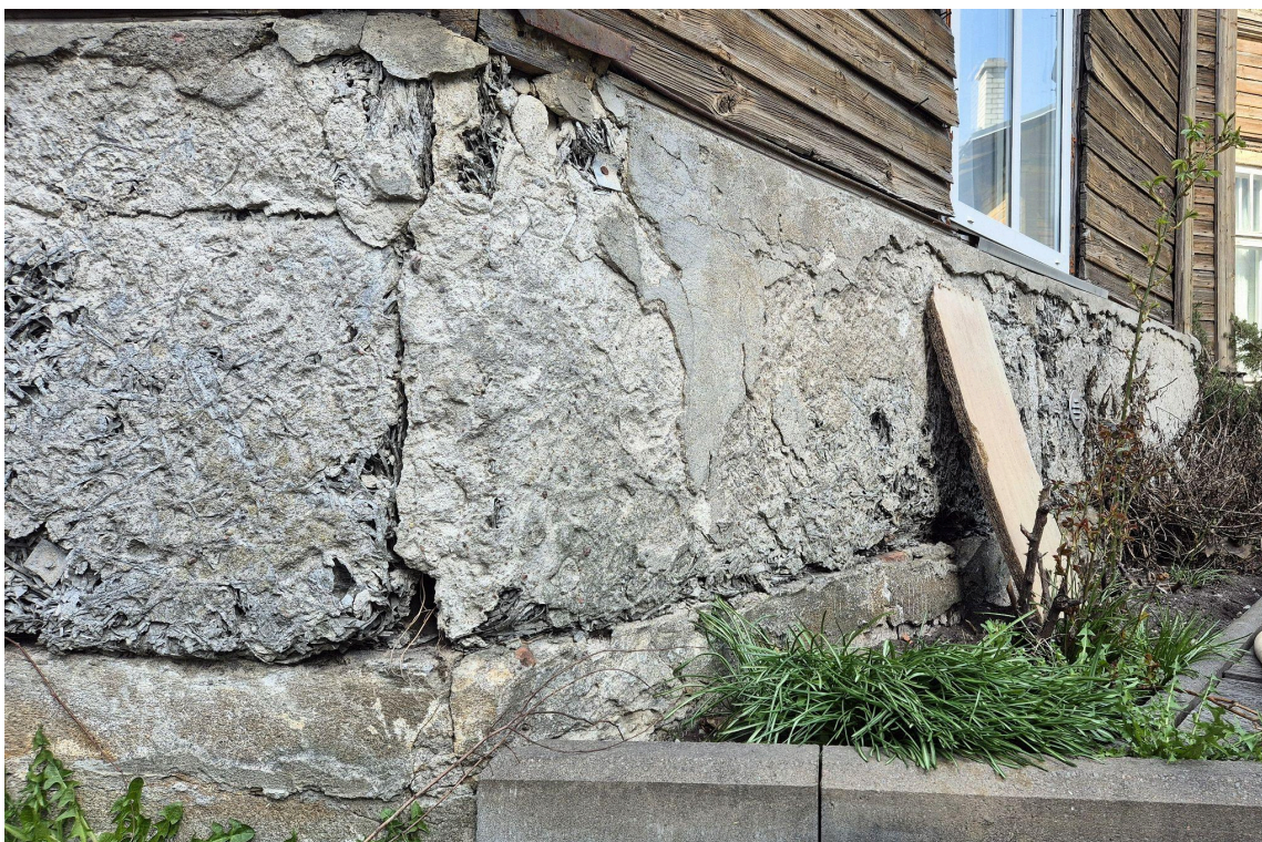
ill 9: Kahjustused soklil, Foto autor: Ivika Puust, 18.04.2025
