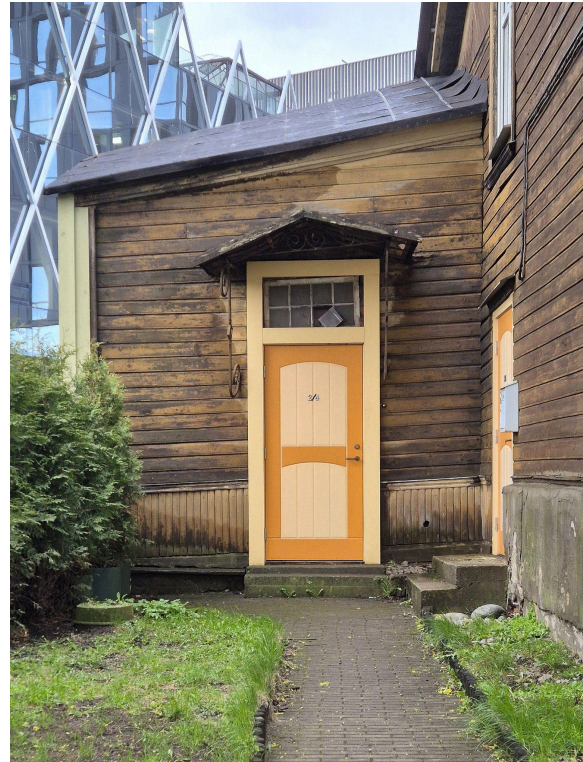
ill 51: Puudulik vihmaveesüsteem on kaasa toonud fassaadi märgumise
