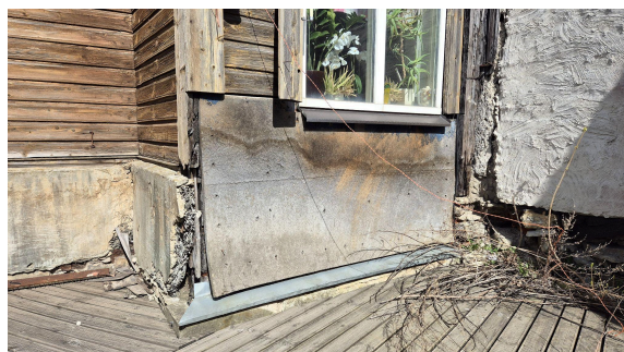
ill 24: Pildil on näha, et suurema kahjustuse varjamiseks ja kaitsmiseks on ette löödud vineerplaat.
