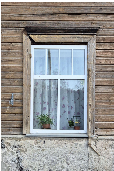
ill 70: Puitaken on asendatud plastikaknaga
