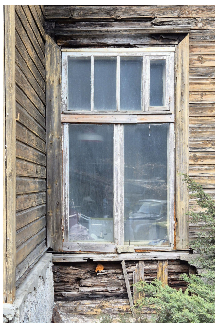
ill 59: Pildil on näha selgeid ilmastikukahjustusi: märgata on värvi koorumist, hallitust ja võimalikku mädanikku. Samuti on näha aknaliistude deformeerumist. Aknaraami on proovitud keskelt suvaliste liistudega tugevdada. Akna karniis ja veelaud on tugevalt degradeerunud.
