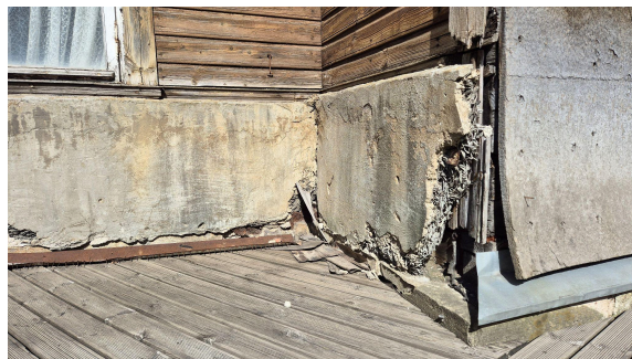
ill 22: Hoone nurgas olev niiskuskahjustus on põhjustatud puudulikust vihmaveesüsteemist.
