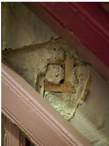
ill 116: lagununud krohvi taga paljastab end võrestiksein, mis ajalooliselt küllaltki levinud on.
