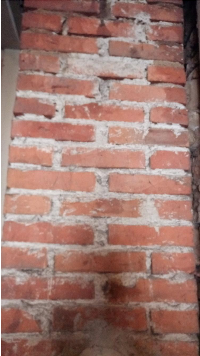
25. Ärklikorrusele minevas esikus olev krohvimata korstnajaalg
