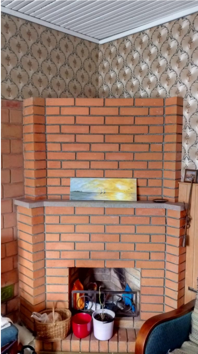
36. Kipsplaatsein ja hetkel mittetoimiv kamin
