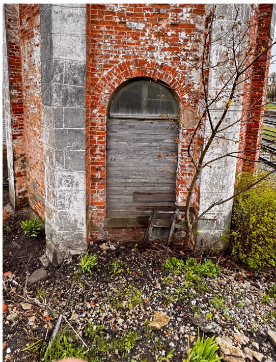
Foto 12. Vundament on mattunud pinnase alla
