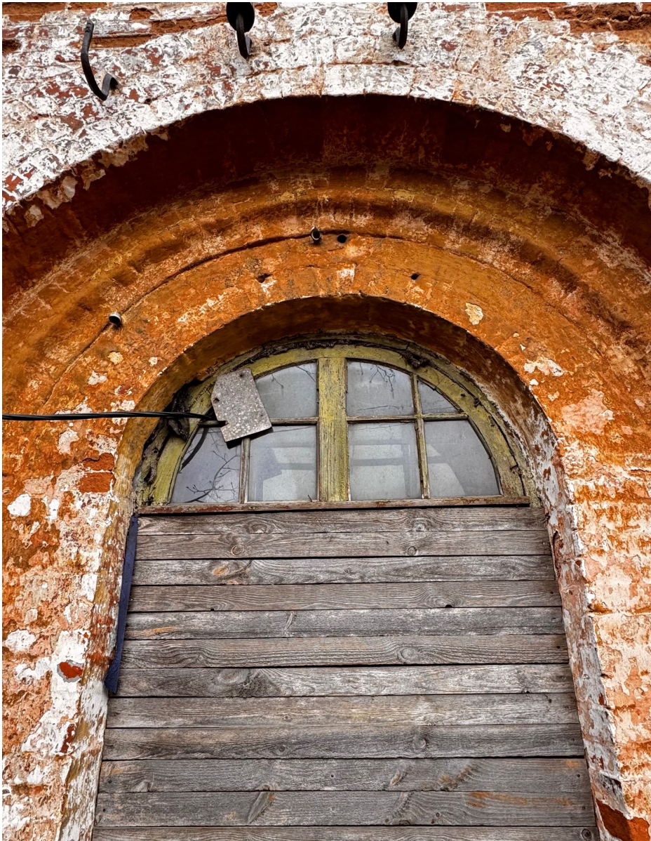
Foto 60. Kohati on aknakitt asendunud puitliistuga
