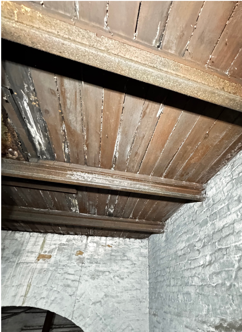
Foto 49. Esimese korruse laes olevad veekahjustused.
