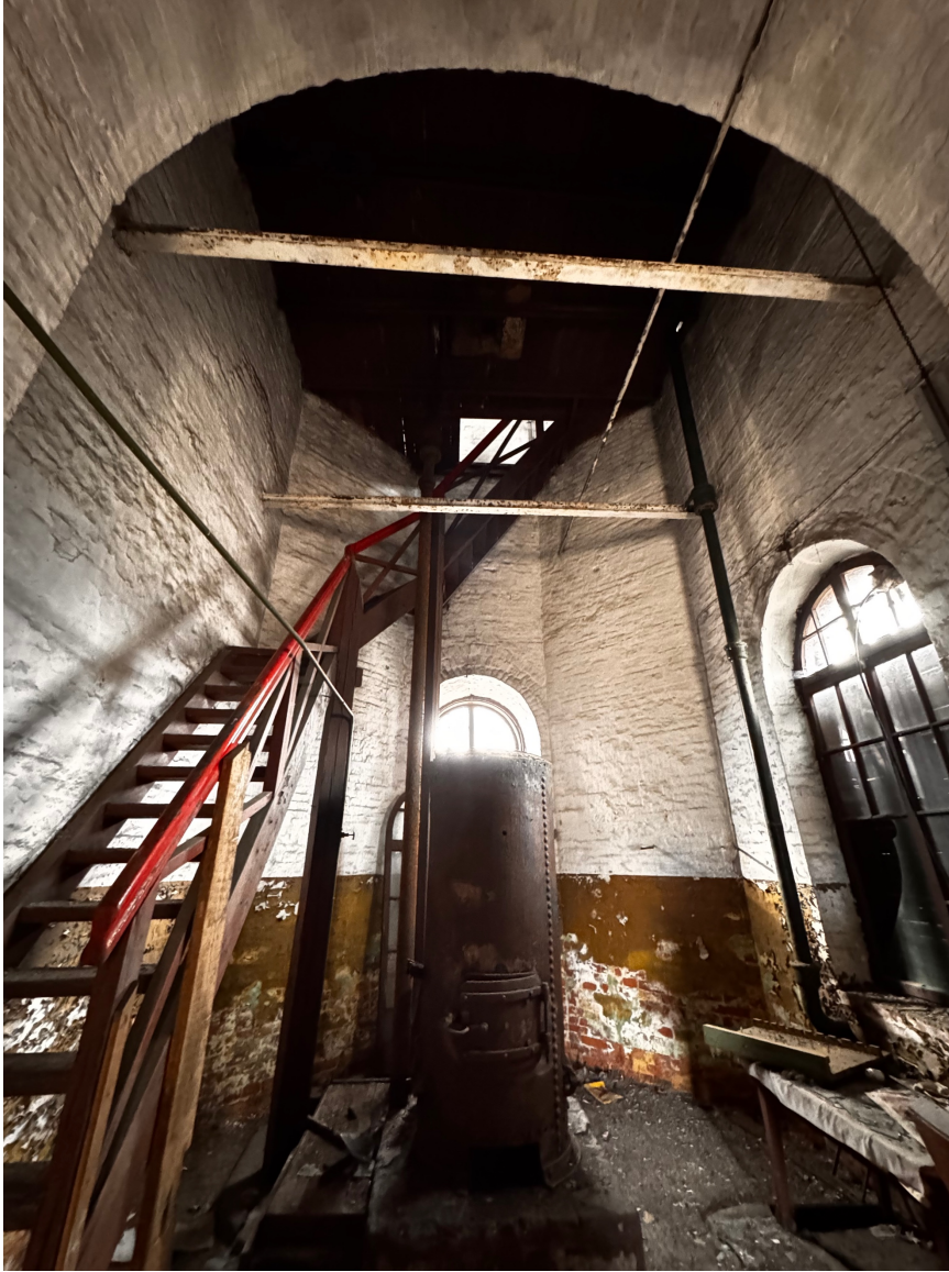
Foto 48. Teisele korrusele viivat treppi on parandatud suvaliste lauajuppidega. Taustal üks kahest auruboilerist Pildilt paistab ka seina altosast pudenenud värvikiht
