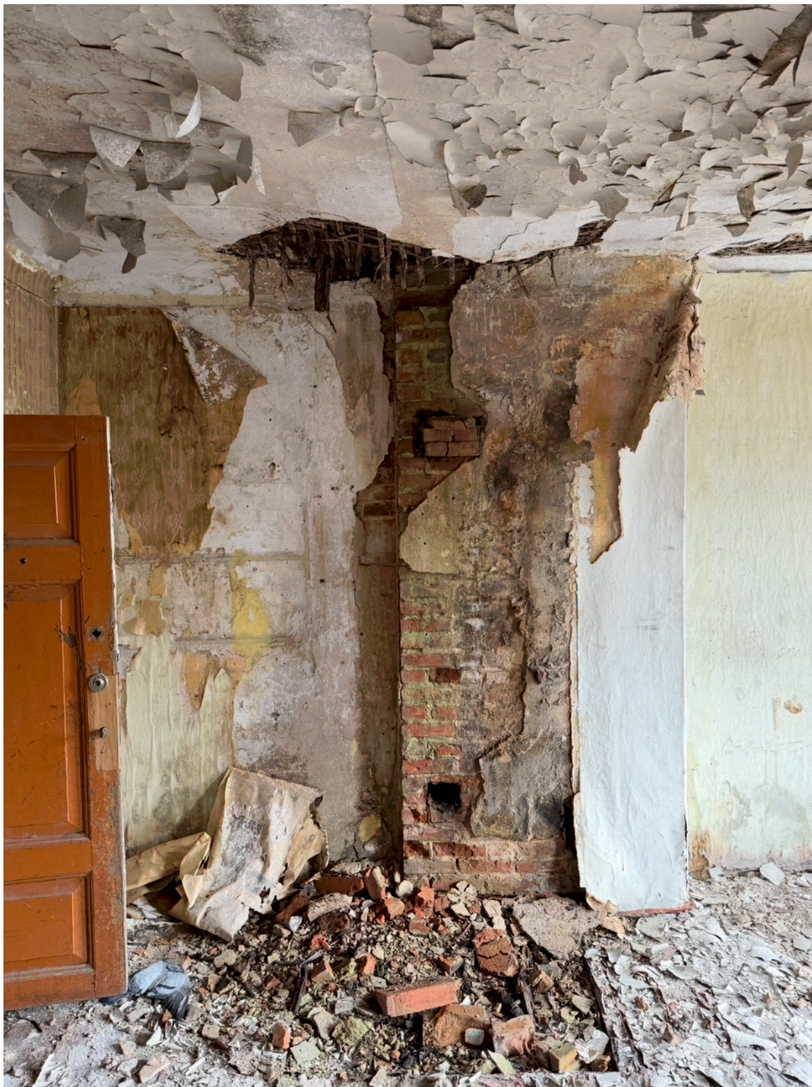
17. Vahelae kahjustused korstnajala ümber, eluruum nr. 7.
