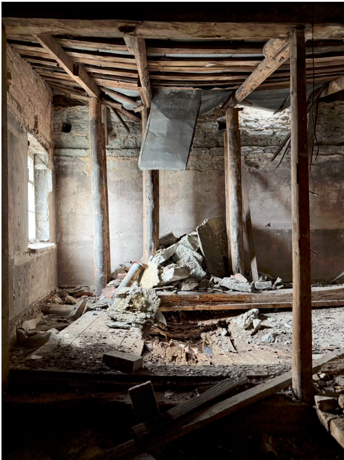
15. Katuse ja vahelae läbivajumine tulemüüri ääres.
