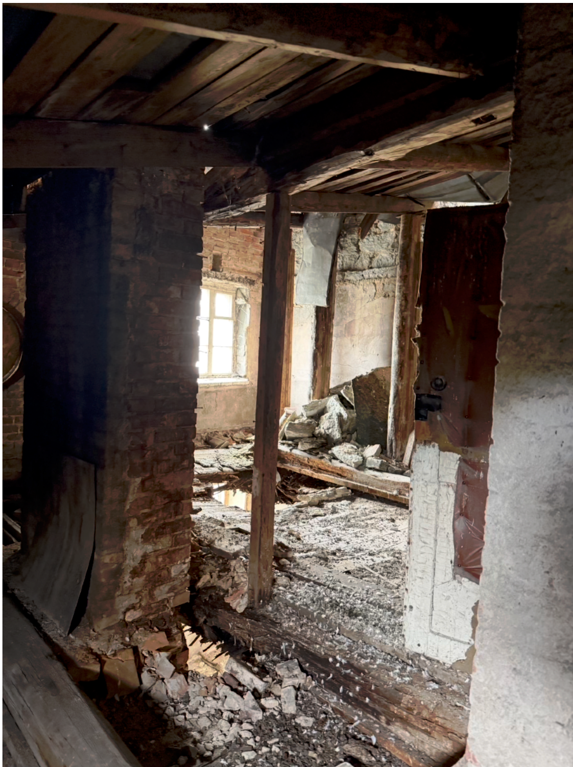
14. Katuse, katusekonstruktsiooni ja vahelae kahjustused.
