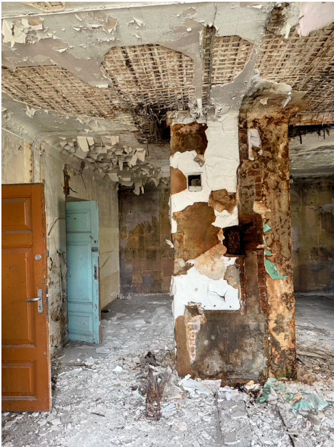
18. Vahelae kahjustused korstna ümber, eluruumid nr. 9 ja 10.
