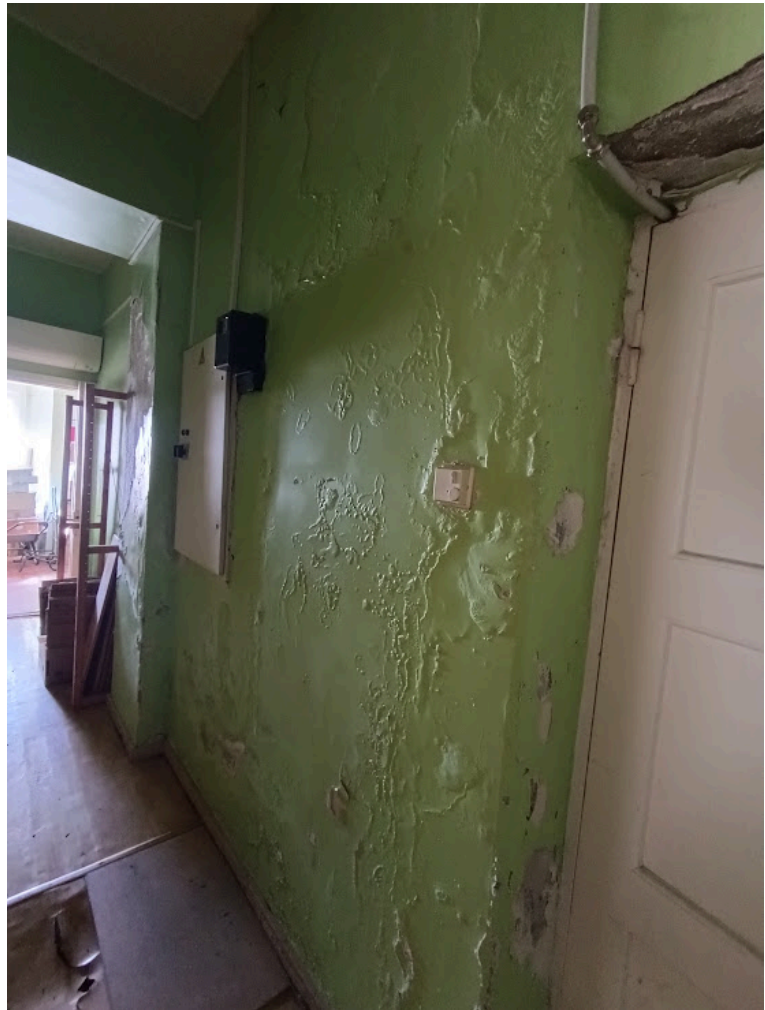
Joonis 12. Siseseina kahjustused
