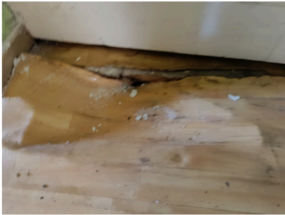
Joonis 16. PVC all kahjustunud põrand ja lainetav põrandakate
