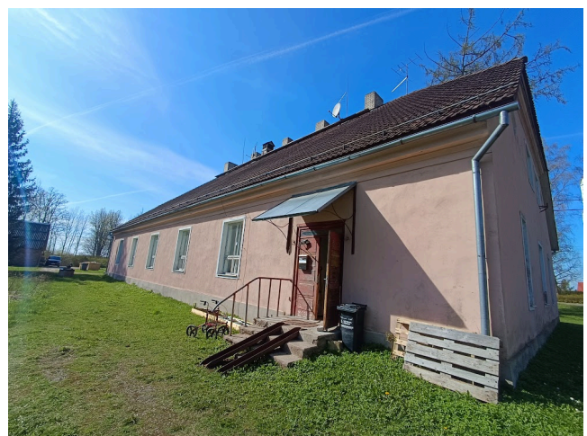
Joonis 20. Katuse lõunapoolne külg
