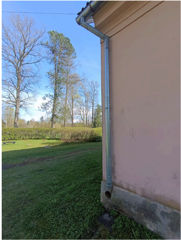
Joonis 9. Sokli veekahjustus, korrastamata vihmavee vastuvõtja
