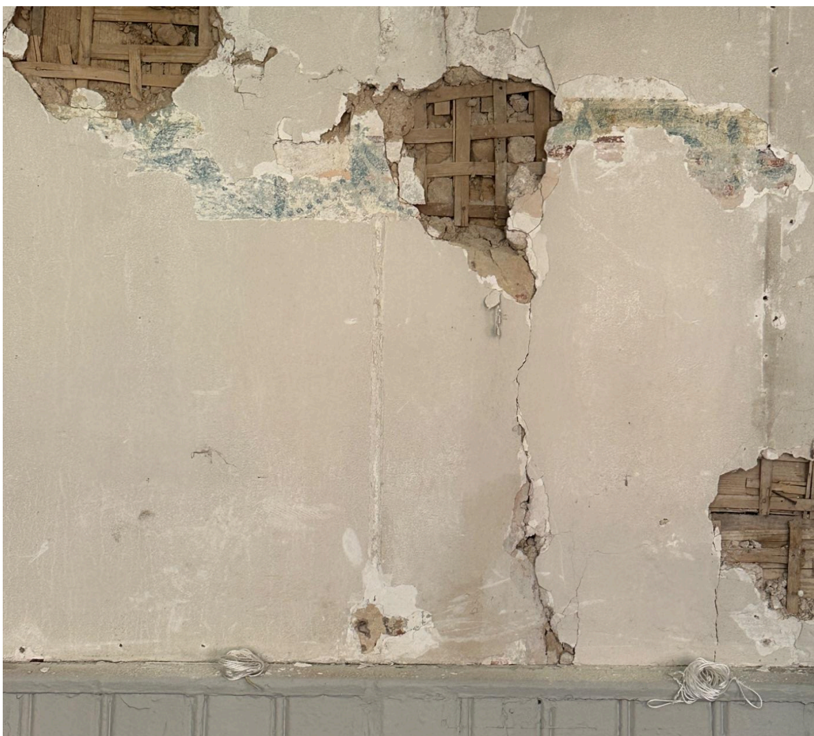
38) Esimese korruse tänavapoolse ruumi seina ülemisest osast välja tulnud trafarettmaaling. Mai 2025.
