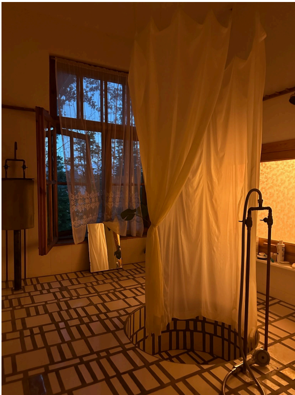
18) VARESe ehitatud vannituba
