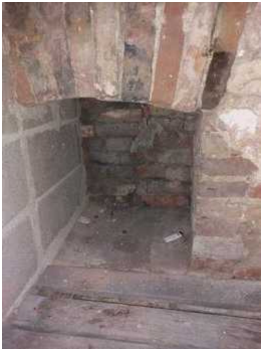
36. Nišš seinas hoovipoolses tagumises keldriruumis. Puuduliku ehitusjärelvalve tõttu ehitati selle sisse plokkidest vahesein, mille peab lammutama.
