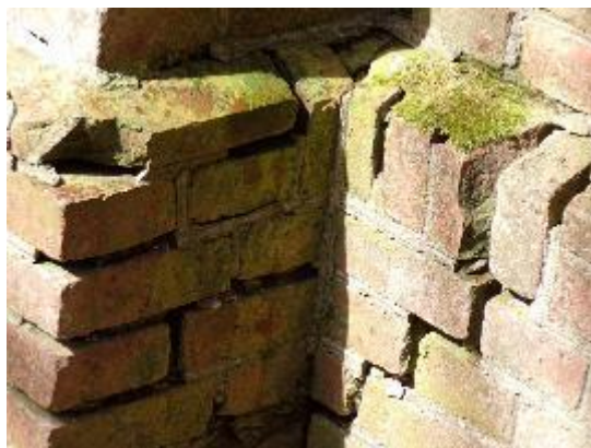
Joonis 16. Värava lõunapoolse külje vasaku posti vundamendi kahjustused (autori foto)
