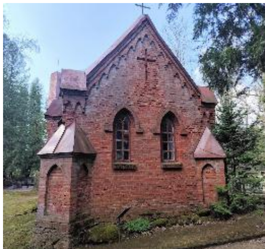
Joonis 20. Idapoolse seina müür, kus akende kohal on näha kahjustunud tellised müüris (autori foto).
