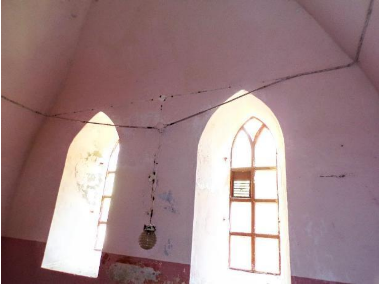
Joonis 41. Elektripaigaldiste seisukord ärasaatmisruumis (autori foto).
