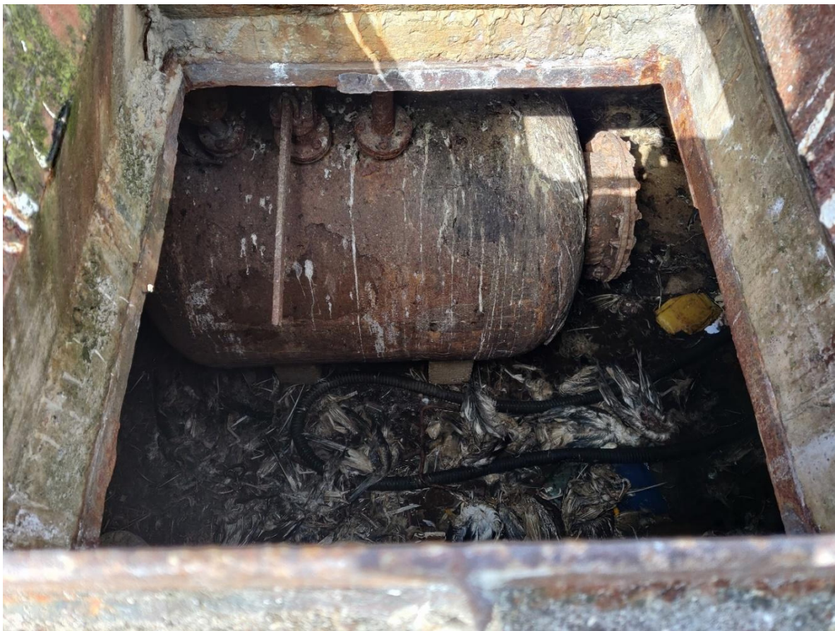
Foto 16. Vaade kütusepumba ruumile sissepääsu luugist. Autori foto, Aprill 2025
