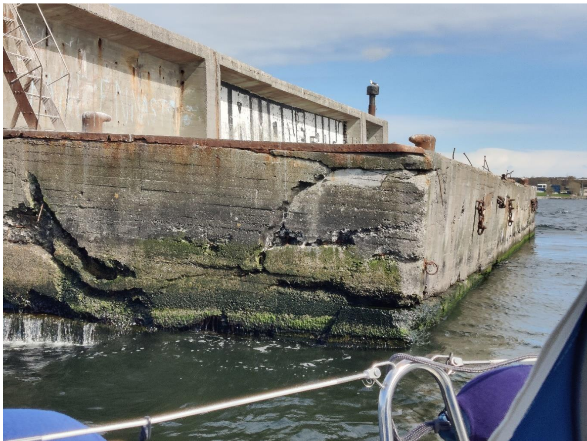
Foto 8. Vaade edelast. Pildil näha laiapindsed kahjustused betoonkonstruktsioonil. Autori fotod, Aprill 2025
