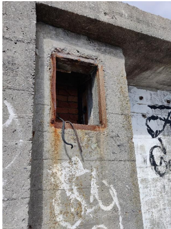
Foto 11. Ventilatsioonilõõr. Autori foto. Aprill 2025
