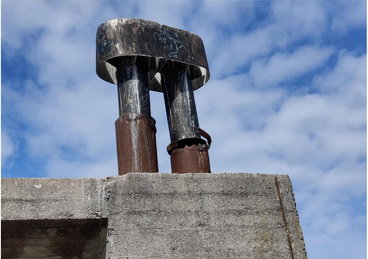
Foto 21. Kütuseruumi korstnad. Parempoolse korstna keevis on läbi roostetanud. Autori foto. Aprill 2025
