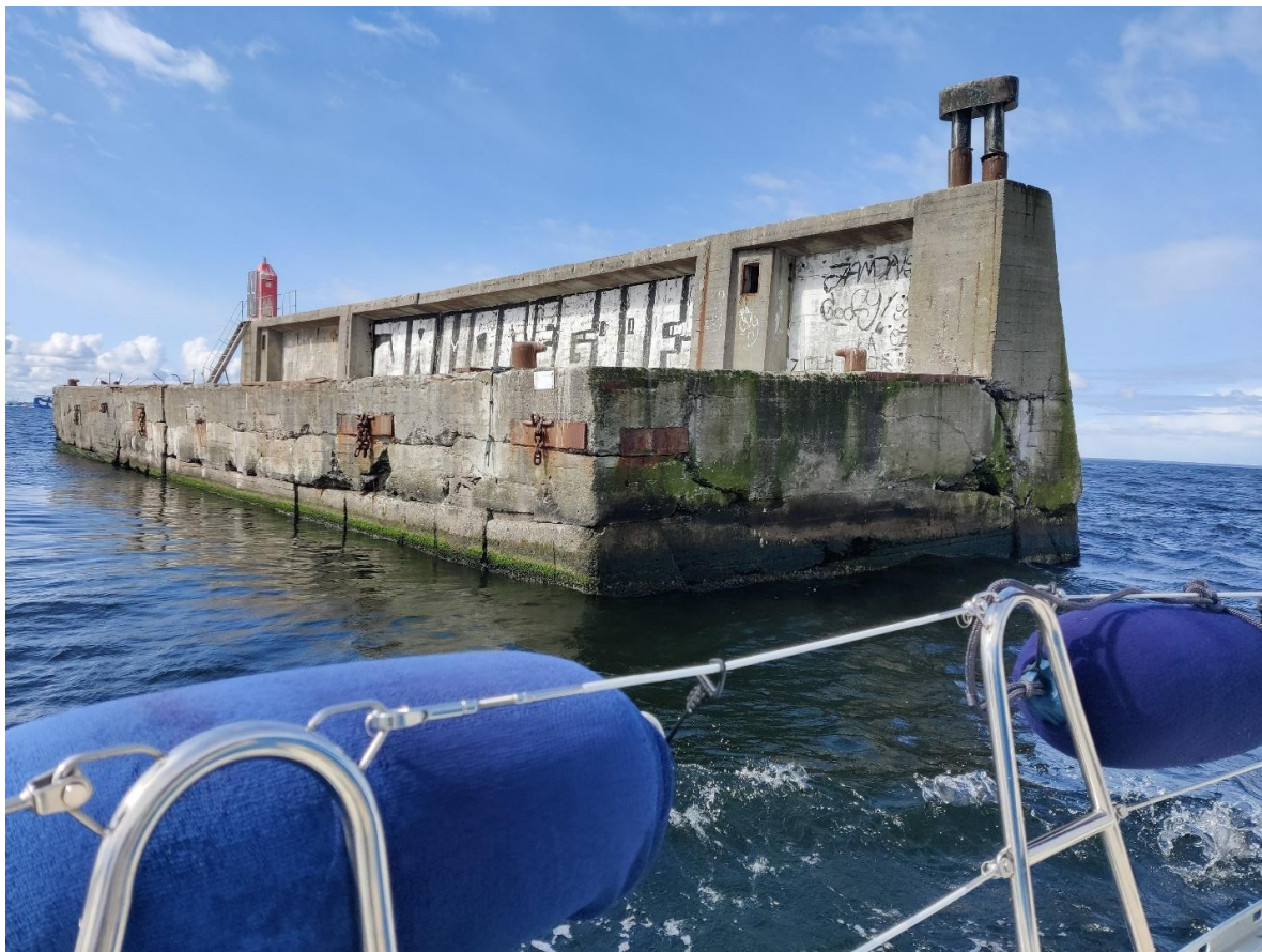
Foto 5. Visuaalne inspeksioon idast. Pildil näha suured betooni kahjustused kirre- ja kagupoolses mahus. Samuti kunagise pääsuredeli asukoht roostese risttahukana tsentris. Autori foto, Aprill 2025
