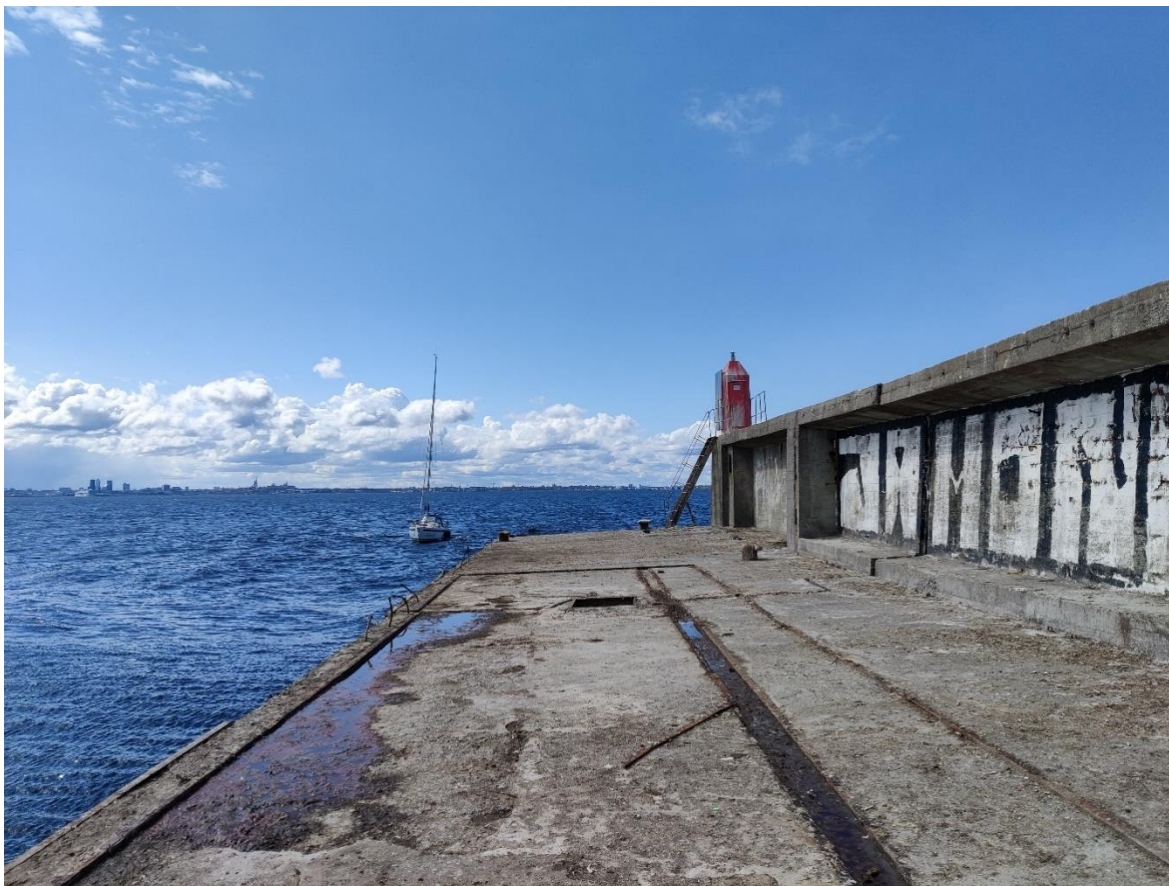
Foto 12. Vaade reidikai kirdepoolsest otsast. Paremat kätt näha kaid läbivast mōrast tulenevat murdekohta. Autori foto. Aprill 2025
