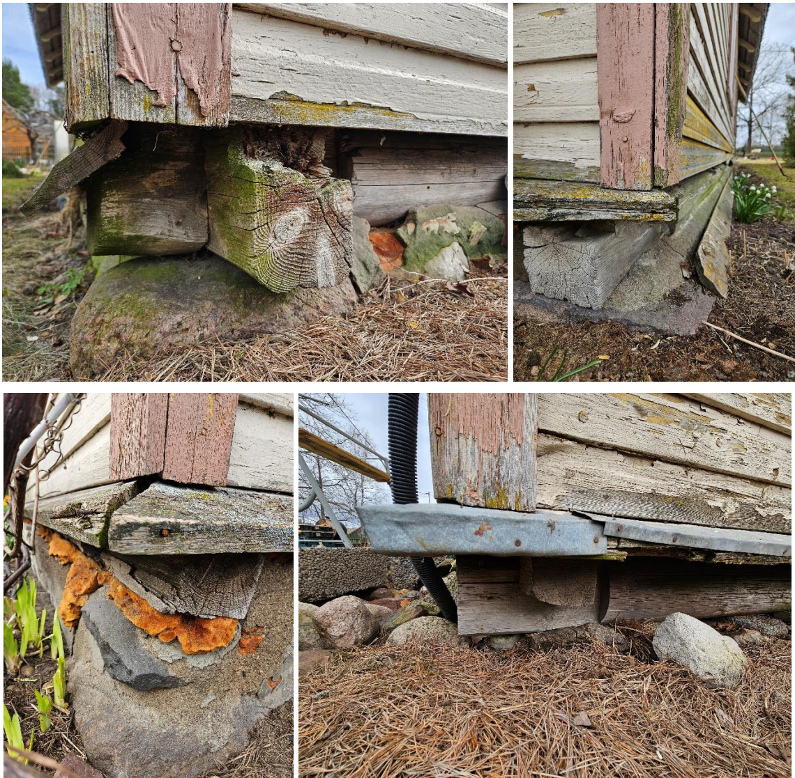
Fotod 4–7. Hoone fassaadi nurkade seisukord. All vasakul on näha käepäraseid parandustöö jälgi. 13.04.2024. Autori foto.
