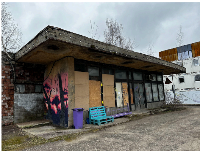
Illustratsioon 26. Vaade hoonele ja katuse vajumine nurgast. Autor: Miia Laur. 2024
