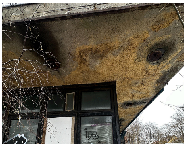
Illustratsioon 27. Katuse seisukord ja kahjustused. Autor: Miia Laur. 2024
