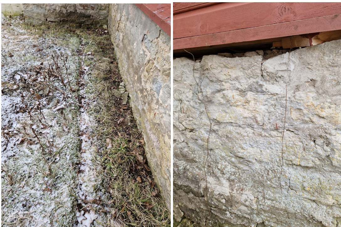
Foto 19. Maapinna kalle hoone suunas, kus on näha soklis niiskuskahjustusi. Foto 20. Tsementkrohvi alt kumab paekivi. 03.2024. Allikas: autor.
