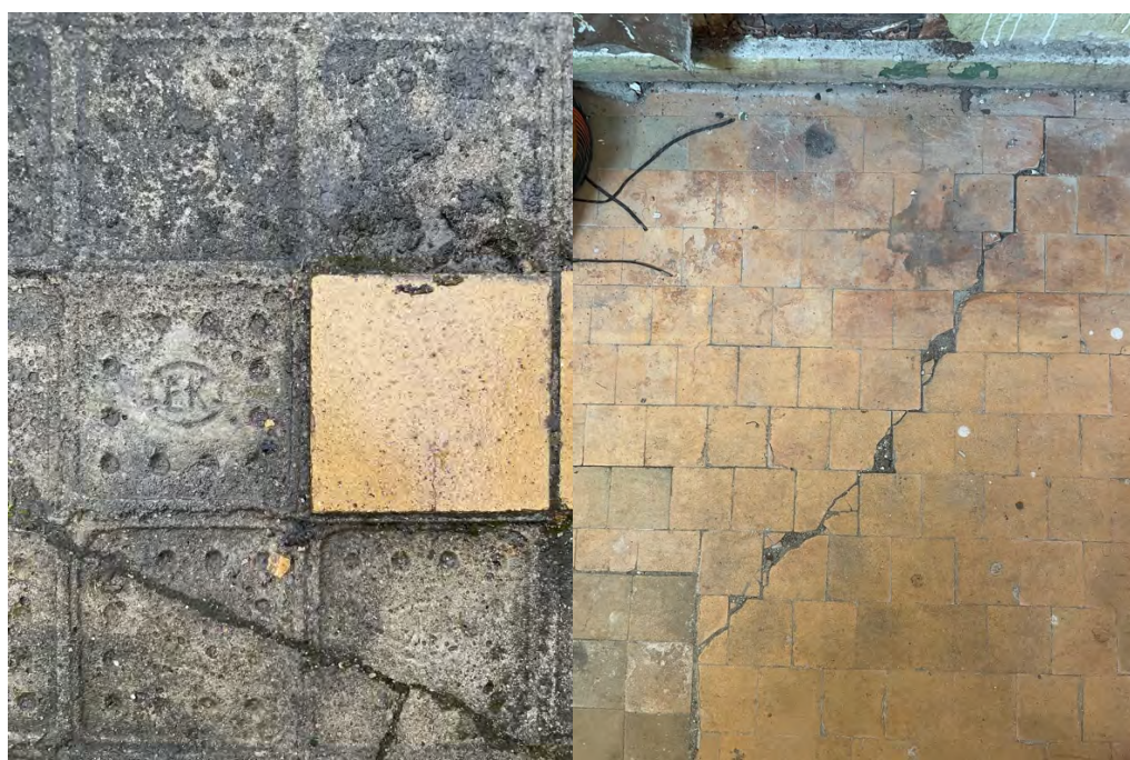
59. Tallinna Ehituskeraamika Tehase (TEKT) põrandaplaadid hoovis (vasakul) ja küpsisevabrikus, mõrad ja pinnase vajumine. Autori fotod.
