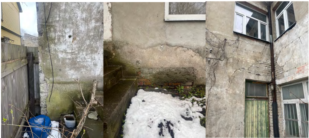
45. Niiskuskahjustused, pudenenud krohv, mõrad seintes, tsementkrohvi parandused. Autori fotod.
