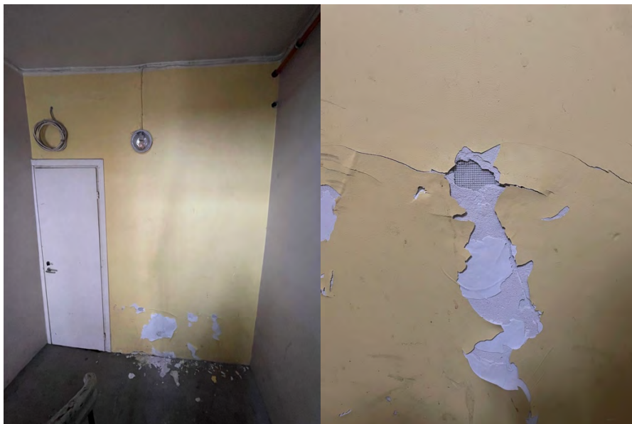
51. Trepikoja siseseinad ja krohvi pudenemine. Autori fotod.
