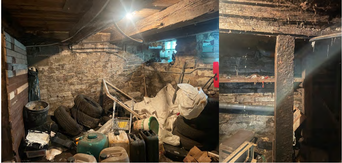
40. Korter nr 1 all asuv keldriruim niiskuskahjustusega puidust vahelae ja taladega. Autori foto.
