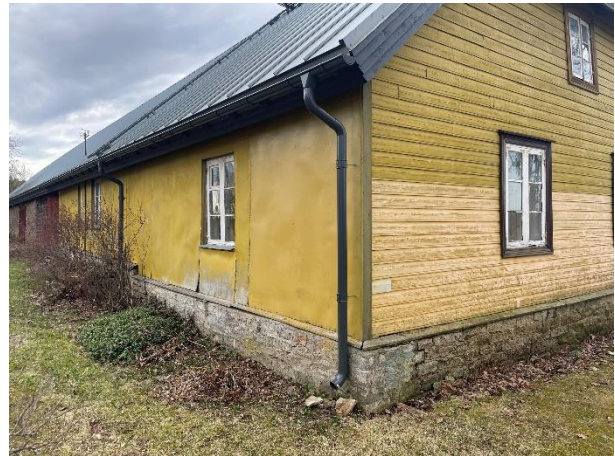
ill 7 Lõuna- ja idafassaad 2024.aastal. Lõunaküljel on näha haljastust, mis kasvab sokli läheduses, puitkiudplaati, sisse astega aknaid, kollase värvimeediumiga värvitud nurgalaudu. Idafassaadil võib täheldada pooleli jäänud värskenduskuuri, kus alumisel perimeetril on uv-tundlikum värvimeedium. Akende kohal on veelaud ja piirdelaud on tume pruuni värvi.
