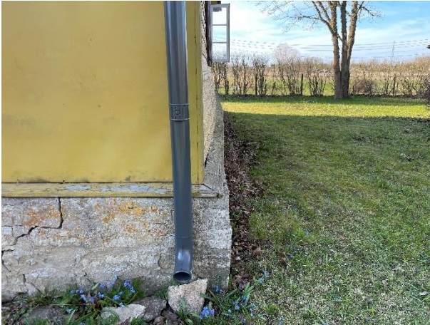
ill 23 Pragu müüritises ning lainetus seinakonstruktsioonis
