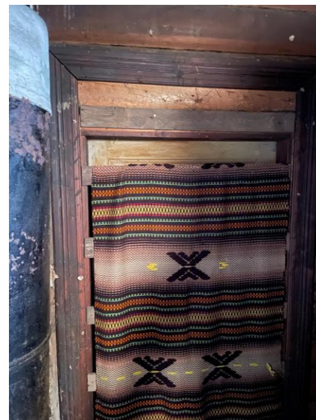
ill 20 I eeskoda eluruum 2-ga ühendav uks, mis on hilisemalt laudadega kinni löödud, kui avaus oma funktsiooni kaotas. Piirdelauad on jäänud puidutooni või ülelakitud, kuid ei ole viidud avausega koos madalamale.
