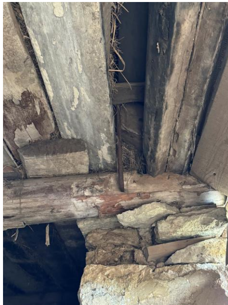
ill 28 Rehealuse põhjavärava sillus on hävinud. Laetalad on ankurdatud katuse konstruktsiooni külge.
