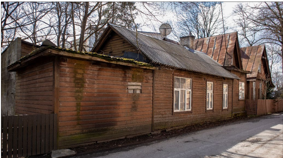
Foto 28 - niiskuskahjustused hoone seinal, vaade Vana Pärnu maantee poolt hoonele hiljem jürde ehitatud osale
