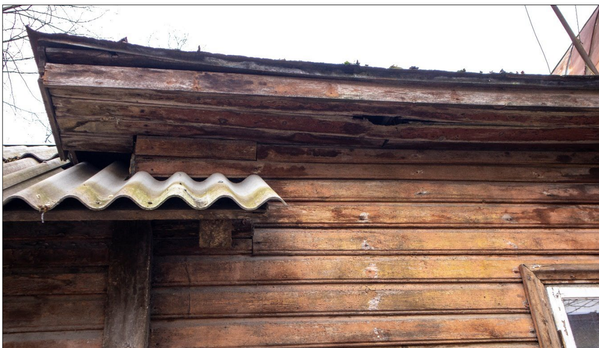
Foto 29 – räästalaud on tugevalt kõmmeldunud ja kahjustunud
