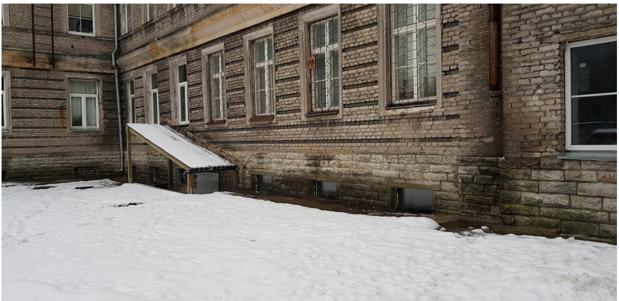
Foto amortiseerunud sadeveetorustikust. 29.12.2023 K.Kaldam
