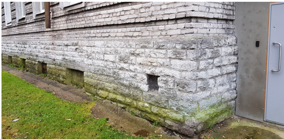
Fotod sillutisriba ja sokli liigniiskuse kahjustusest. 15.11.2023 K.Kaldam
