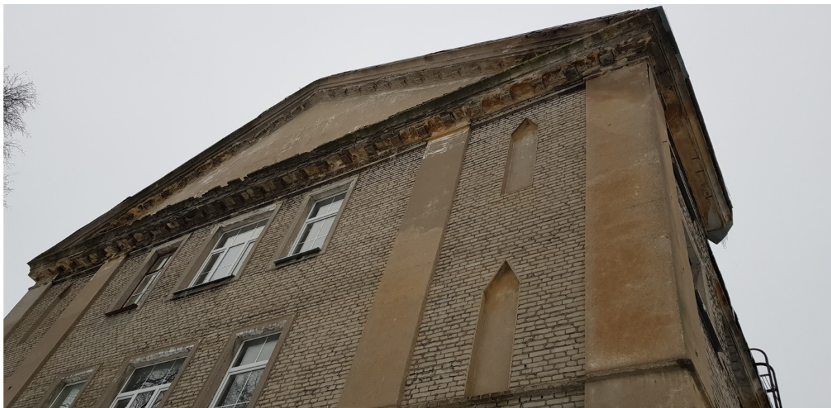
Foto kahjustunud hammaskarniisist. 29.12.2023. K.Kaldam
