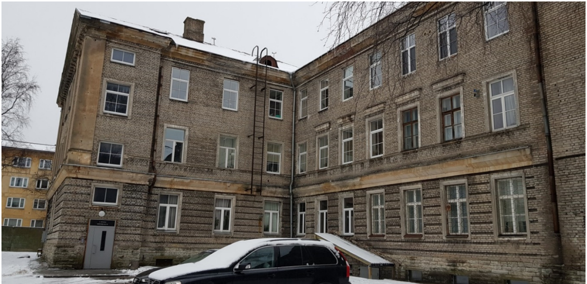
Foto kumervuugiga tellisseinast ja amortiseerunud evakuatsiooniredelist. 29.12.2023. K.Kaldam
