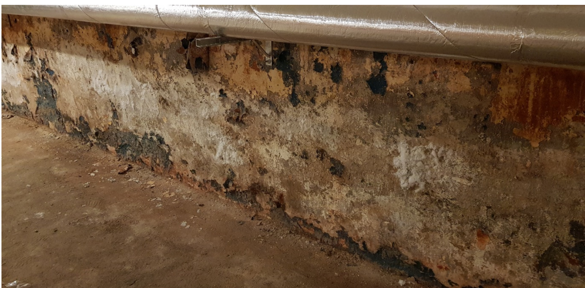
Foto soola kahjustusest keldris. 23.03.2024. K.Kaldam
