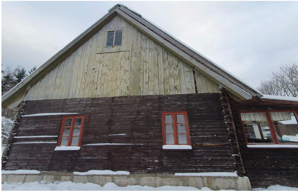
Illustratsioon 13 Hoone n-ö läänepoolne külg koos väljaehitatud kelpkatuse osaga ja maja kõrge vundamendiga. Foto autor: Cäroly Anton, november 2023.
