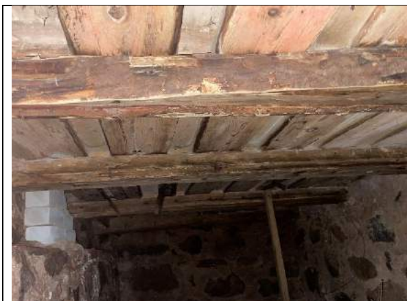
Foto 27. Pehastunud laetalad keldriruumis.
