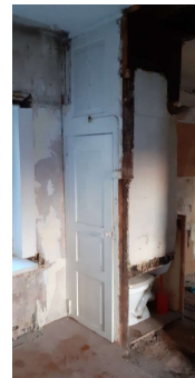
fotol 1951 aasta plaanidel kuvatud situatsioon väikesest tualetist köögi tagaküljel
