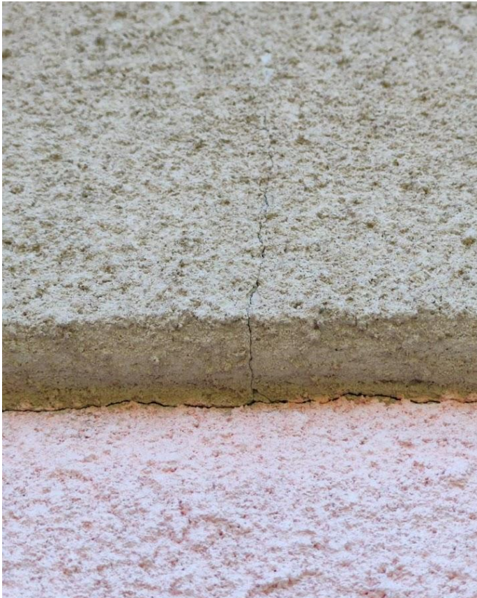
Pilt 17. Lääne fassaad. Pragu krohvikihis esimese ja teise korruse seinte liitumiskohas. Autori foto. 2023.
