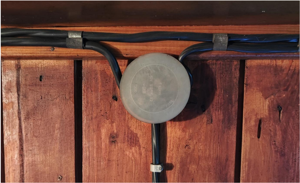
Pilt 30. Originaalne elektrijuhtmestik magamistoas. Autori foto. 2023.
