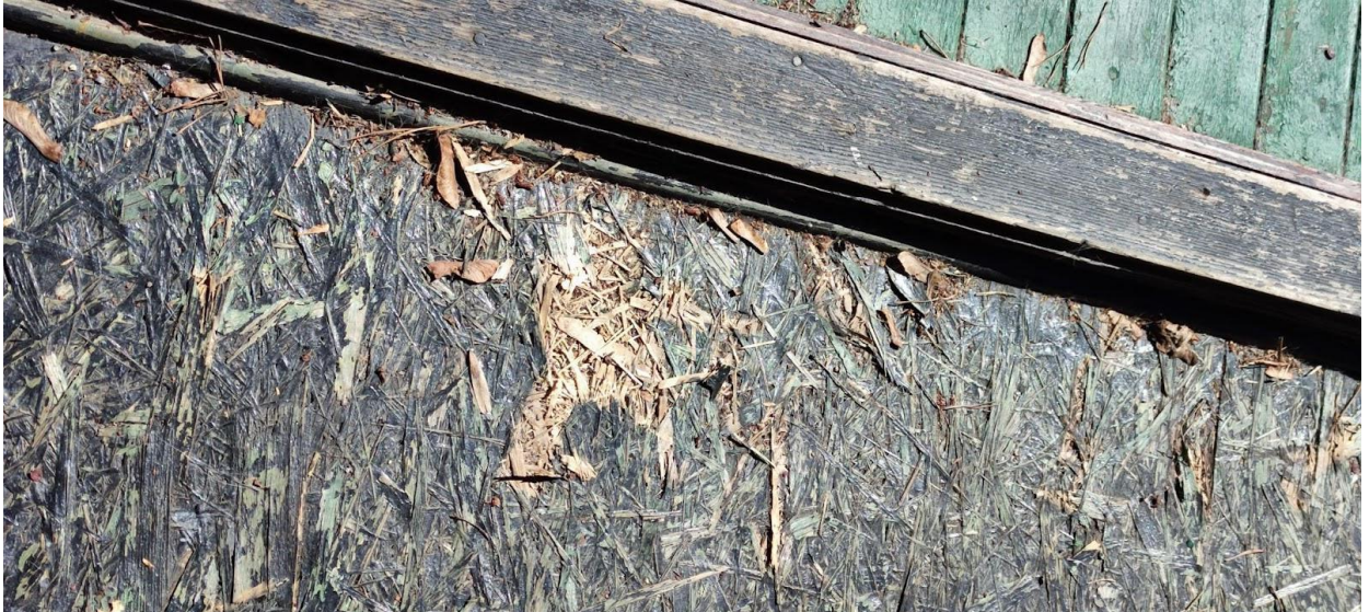
Pilt 14. Niiskuse mõjul kahjustunud terrass. Autori foto. 2023.
