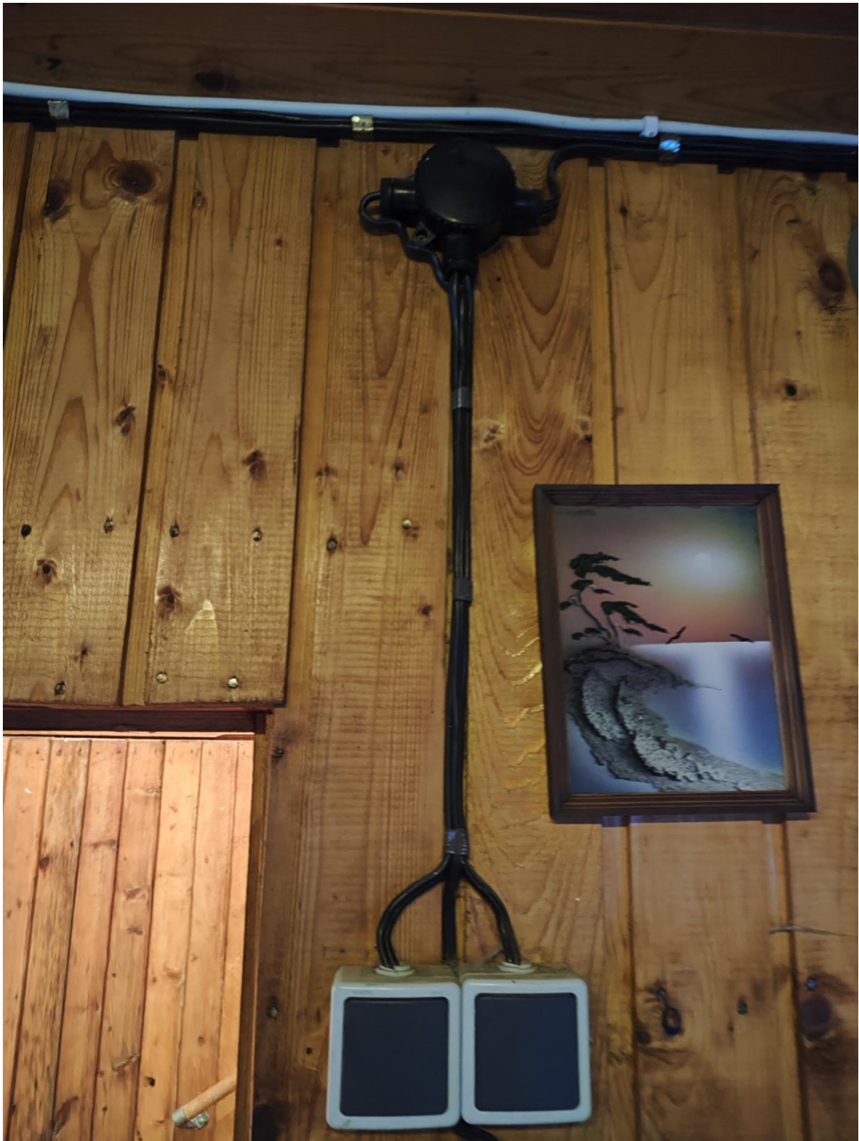
Pilt 32. Originaalne elektri juhtmestik sauna eesruumis. Autori foto. 2023.
