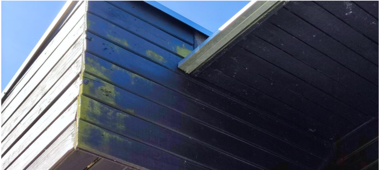
Pilt 12. Põhja poolse karniisi laudad niiskuskahjustustega. Autori foto. 2023.
