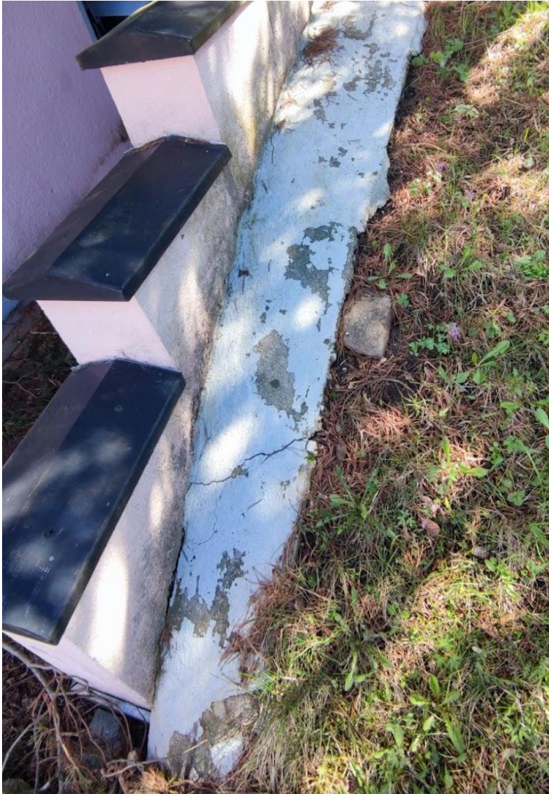
Pilt 22. Tugiseinal kulunud värv ja hallitanud krohv. Autori foto. 2023.
