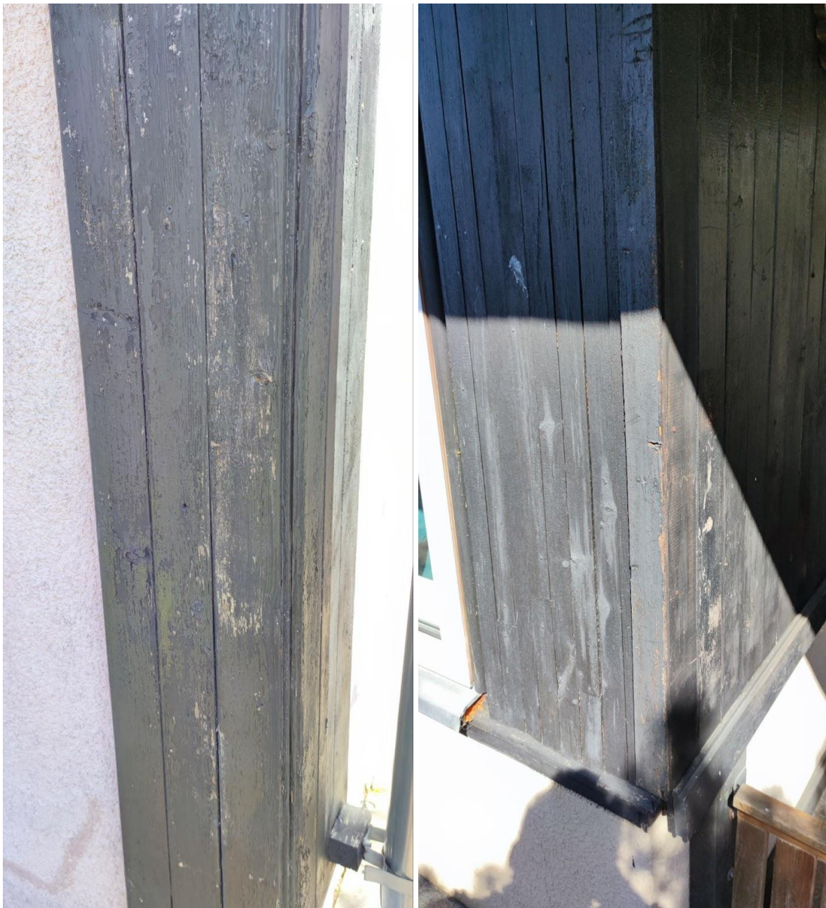
Pilt 11. Lääne ja lõuna fassaadi vertikaalselt paigutatud puitlauad, kahjustunud päikese mõjul. Autori foto. 2023.
