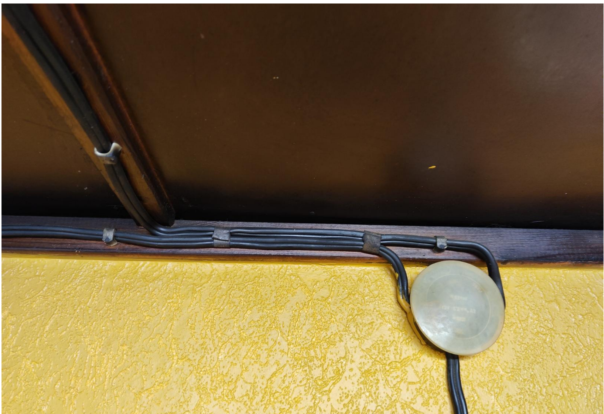
Pilt 31. Originaalne elektrijuhtmestik köögis. Autori foto. 2023.
