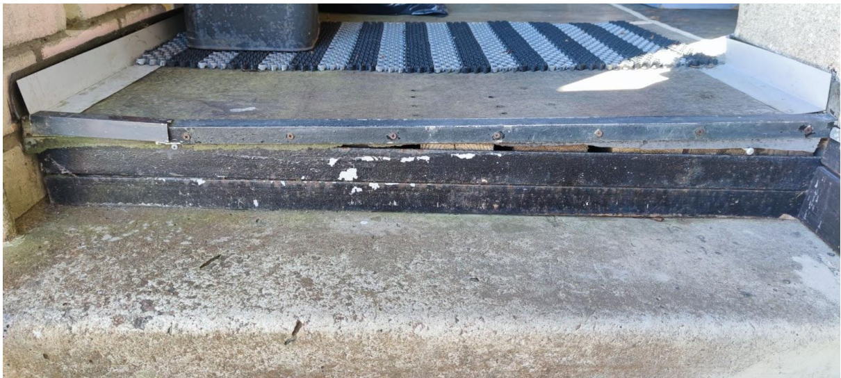
Pilt 13. Niiskuse mõjul kahjustunud terrass. Autori foto. 2023.
