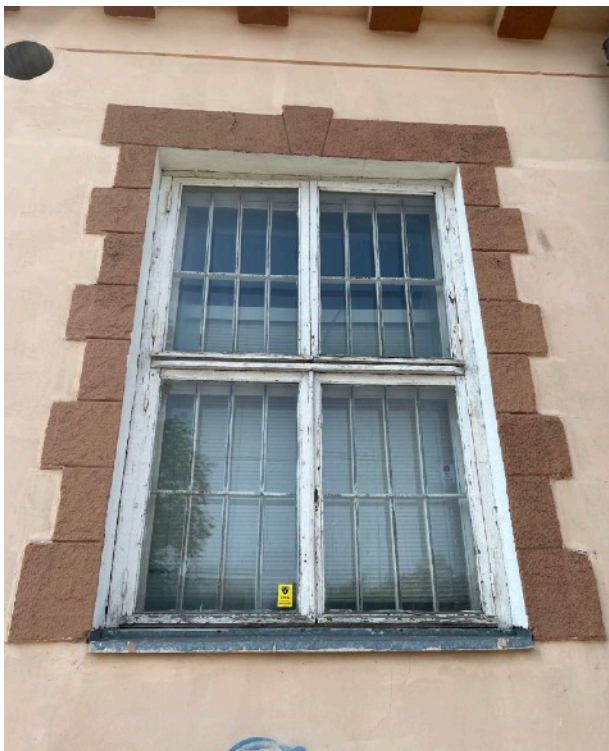
Pilt 37. Tööstushoone esifassaadi aken. Näha akna ümber tehtud lihtne, kui kontrasti loov dekoratiivne raam. Samuti näeb akna alla paigaldatud plekist aknalauda. (Allikas: Autor)
