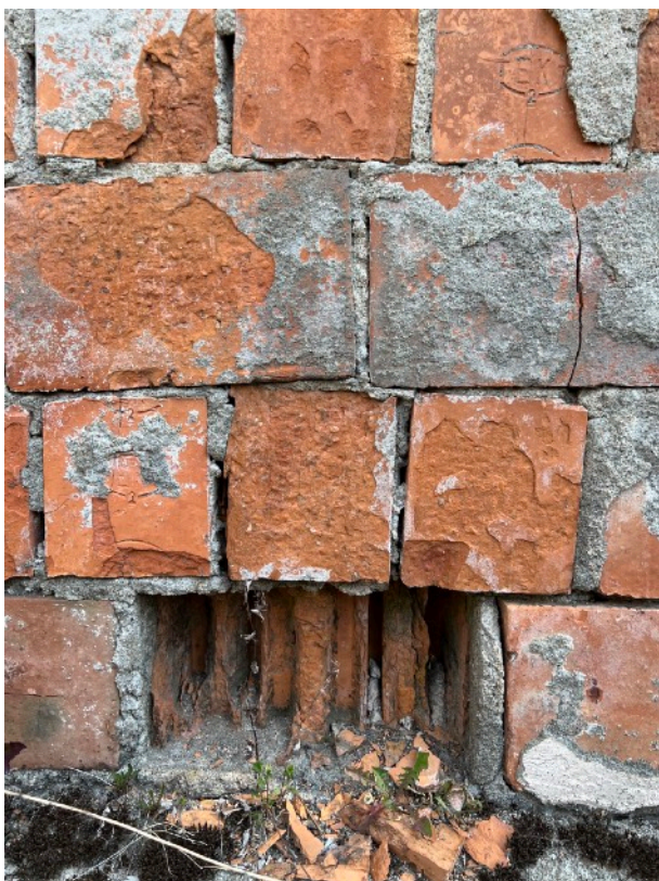
Pilt 21. Tööstushoone esimese juurdeehituse lähivaade. Näha Tallinna Ehituskeraamika Tehase (TEKT) telliskividest rist-seotist. (Allikas: Autor)
