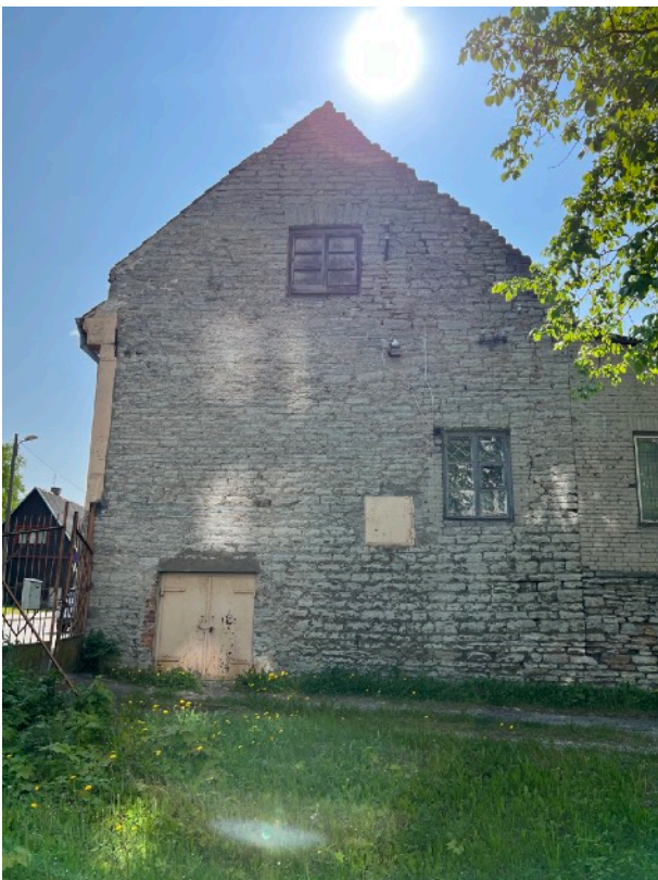
Pilt 18. Tööstushoone Lasnamäe tn. poolne fassaad - on näha, et antud fassaad on püsinud suhteliselt heas korras; fassaadi alusmises osas on kive sidumaterjal vahel kahjustada saanud.; esimese korruse akna servadesse on silikaattellisest täidet laotud; katuse alusel osal on kividel suuremas koguses sidusainet kadunud. (Allikas: Autor)
