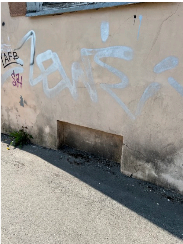
Pilt 16. Tööstushoone tänavapoolse fassaadi liitmusikoht tänavaga - on näha, et hoonel esineb fassaadisisesid veekahjustusi, kuid vajumis vm. kahjustused ei tundu suured olevat. (Allikas: Autor)
