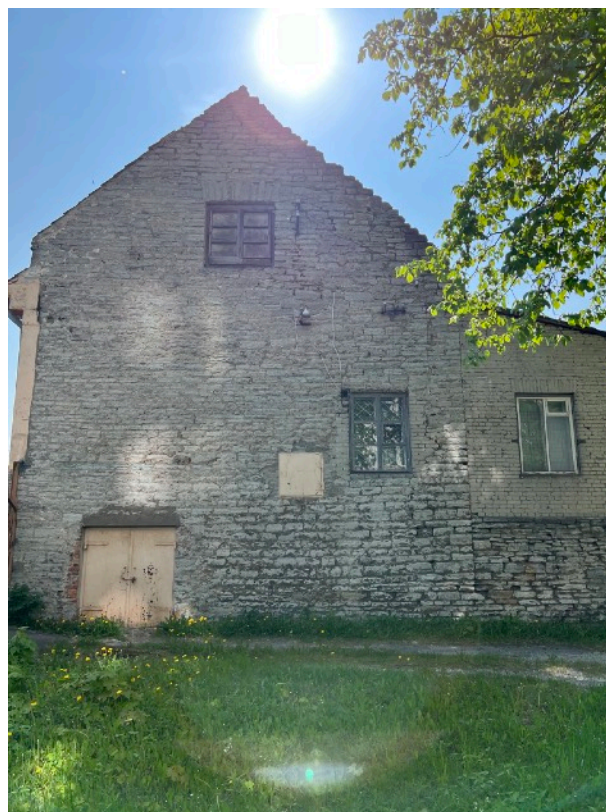
Pilt 33. Tööstushoone külg. Näha akende algupäraseid jaotusi; teise korruse aknalt on klaas eemaldatud ja see puiduga kinni pandud. (Allikas: Autor)
