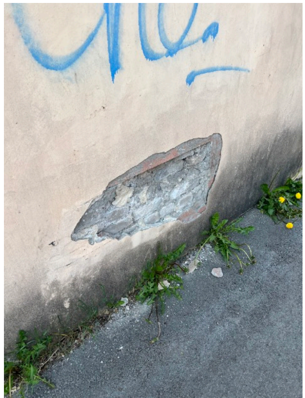
Pilt 17. Tööstushoone tänavapoolne fassaad, kust on näha eeldatavasti tahtliku inimtegevuse poolt tekitatud kahjustusi fassaadile. (Allikas: Autor)
