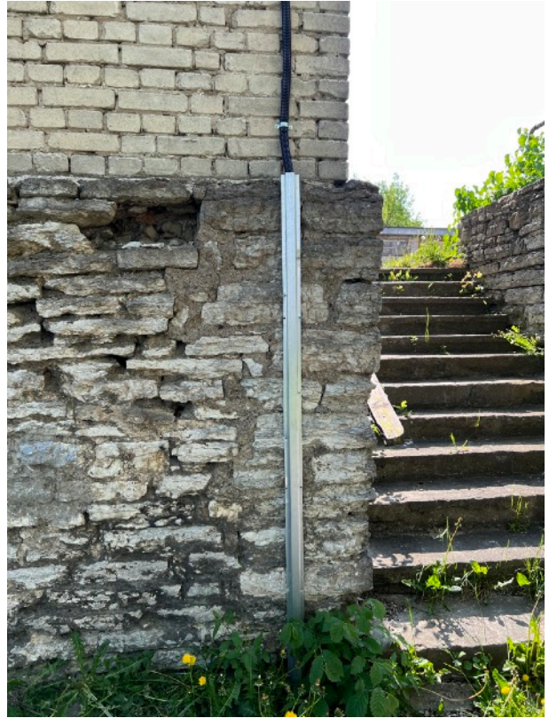
Pilt 12. Tööstushoone juurdeehituse nurk. Pildilt on näha, kuidas välised tegurid on kivist vundamendi liidet kahjustanud, eemaldades kivide vahelist lubjamörti ja muutes vundamendi nii nõrgemaks, tuleviku vaadates isegi ohtlikuks. (Allikas: Autor)
