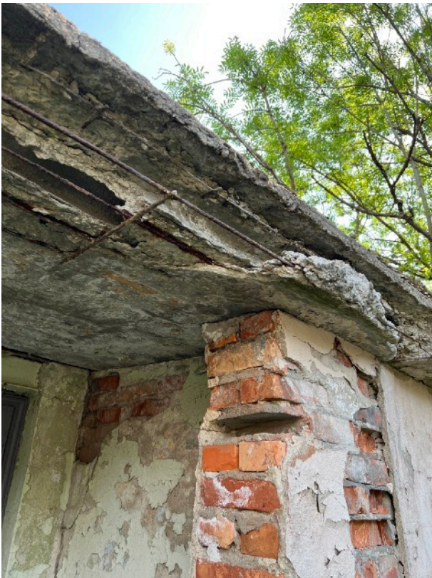
Pilt 23. Tööstushoonele juurde ehitatud ukse varjualune, mille seisukord on halb (raudbetooni armeering on näha) (tellised on kohati ära lagununud, kuid sideaine on säilinud). (Allikas: Autor)
