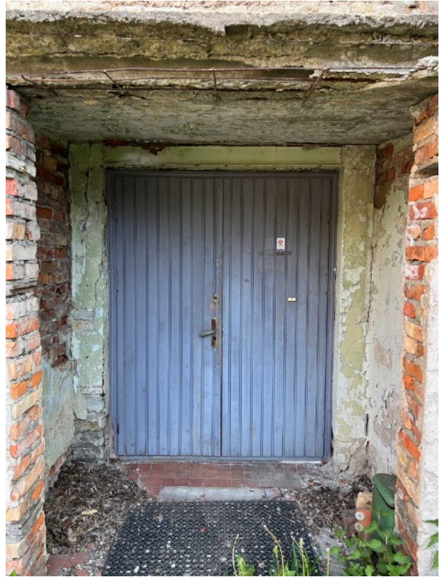
Pilt 36. Tööstushoone aiapoolse külje uks. Ukse stiilist ja terasest rõhthalast aru saada, et uks on hilisemal ajal uuem pandud ega ole algupärane. (Allikas: Autor)
