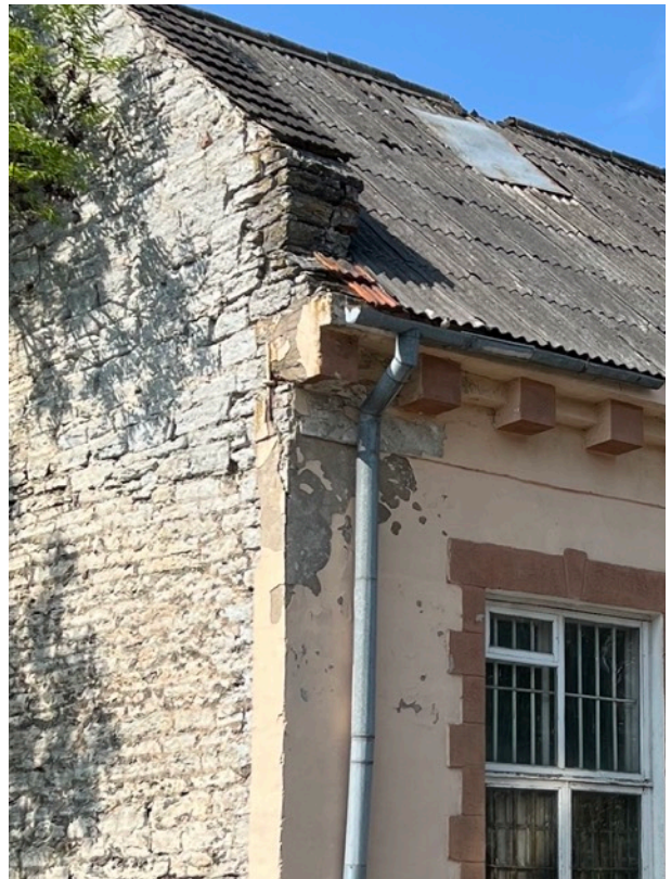
Pilt 15. Tööstushoone kagu nurga kahjustused nähtavana tänavalt; kõige suuremad probleemid esinevad vihmaveerenni nurgakohas. (Allikas: Autor)
