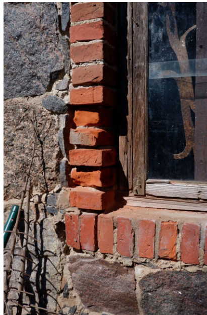
Vasakul. Joonised 16 ja 17. Avasid ääristavate telliste vahelt on vihm segu välja uhtunud ja samuti ka telliseid kahjustanud. Autori foto.
