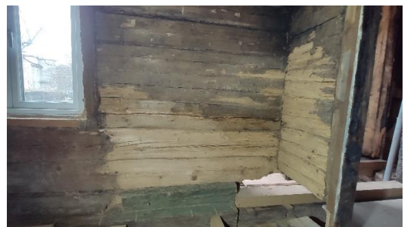
25. Toonesepa kahjustused esimesel korrusel (autori foto)
