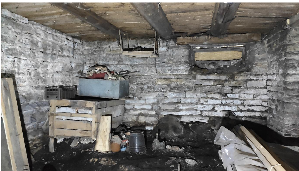
16. Keldriseinad ilma läbivate pragudeta (autori foto)
