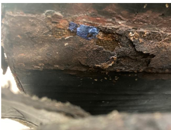
21. Korrodeerunud ja purunenud siseliist.
