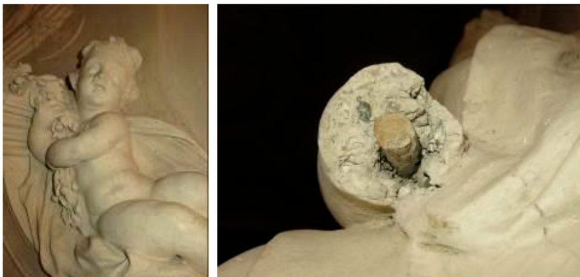
7. Casa Cantoni etnograafiamuseumis kamin kahjustunud stukkdekoori element
